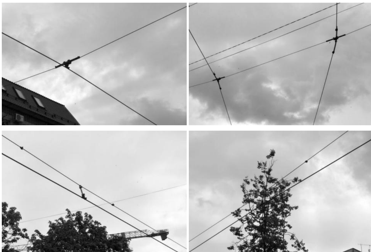
Рисунок 2.348 – Контактный провод трамвая
