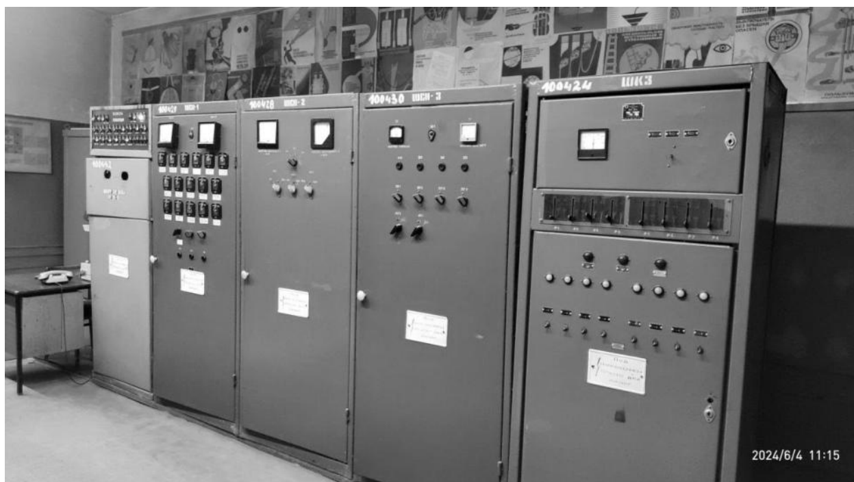
Рисунок 2.247 – Шкафы собственных нужд на ТП-1
