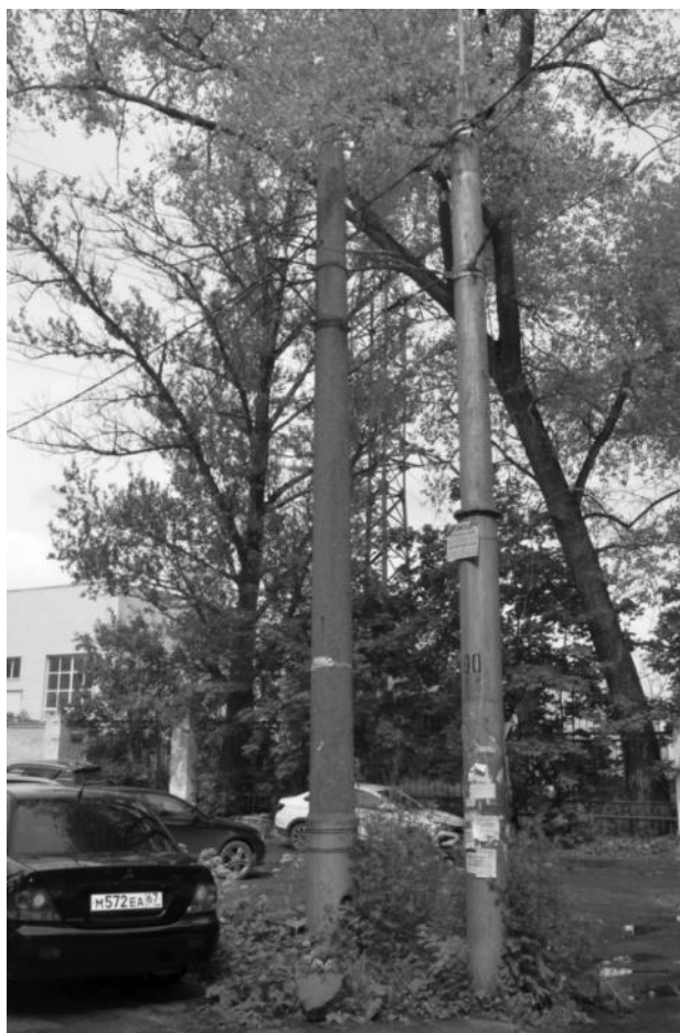
Рисунок 2.273– Железобетонная опора контактной сети
