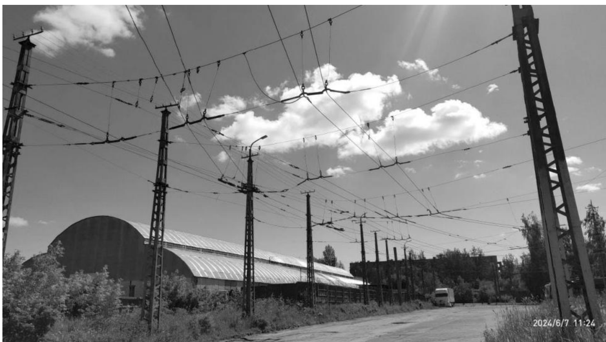
Рисунок 2.43 – Общий вид контактной сети троллейбусного депо
