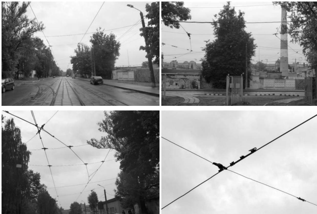
Рисунок 2.397 – Контактный провод трамвая
