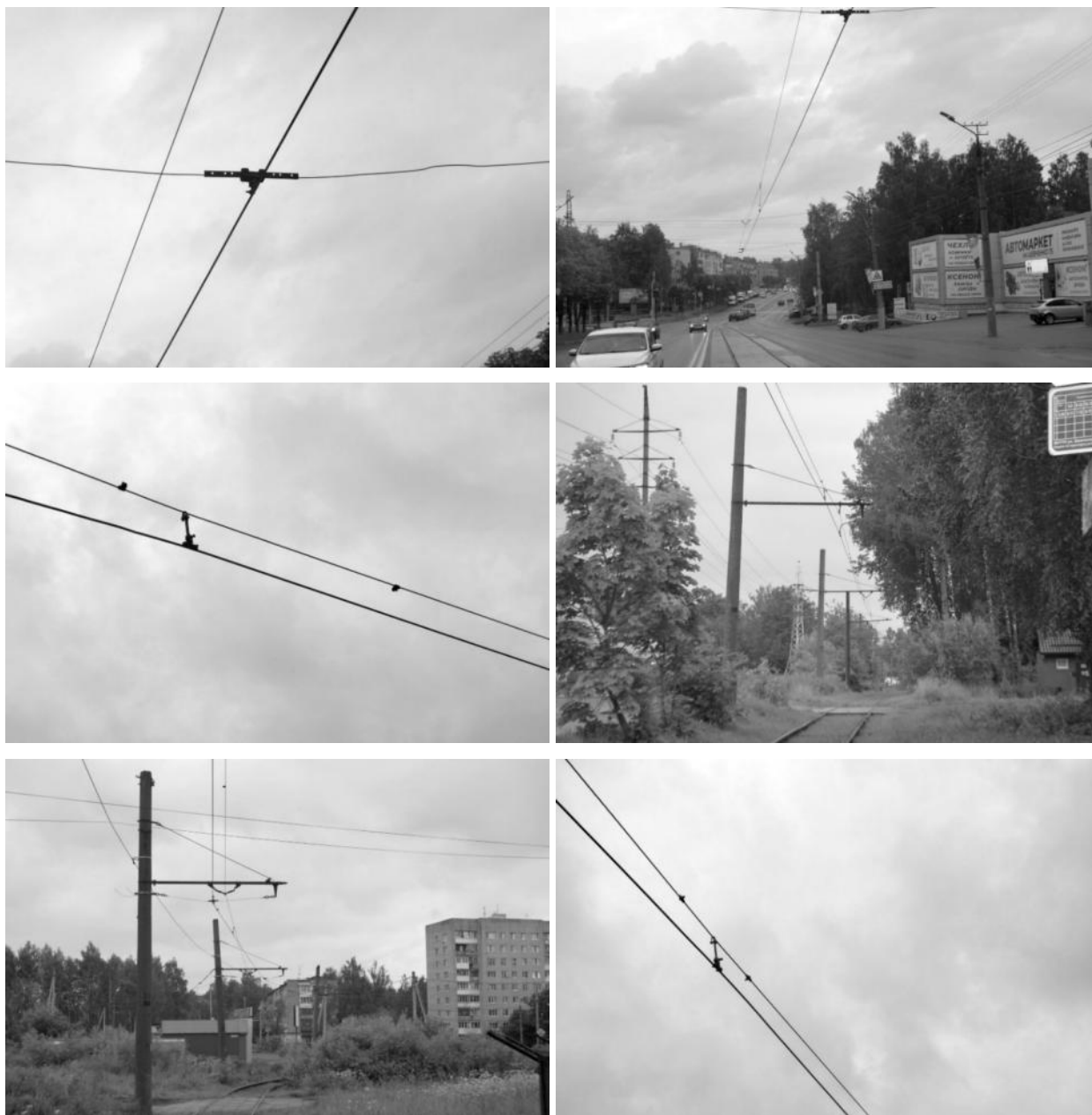
Рисунок 2.457 – Контактный провод трамвая
