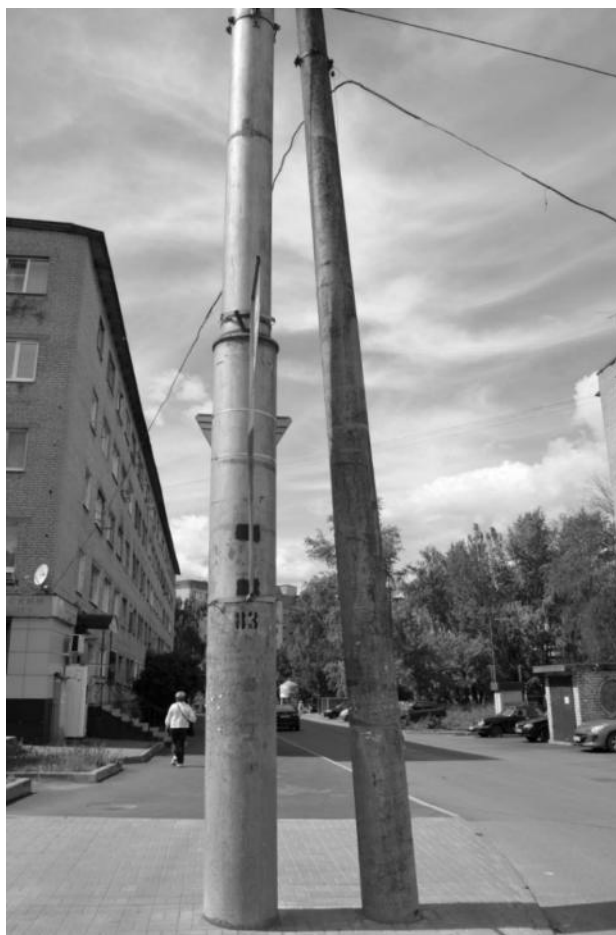
Рисунок 2.534 – Железобетонная опора контактной сети
