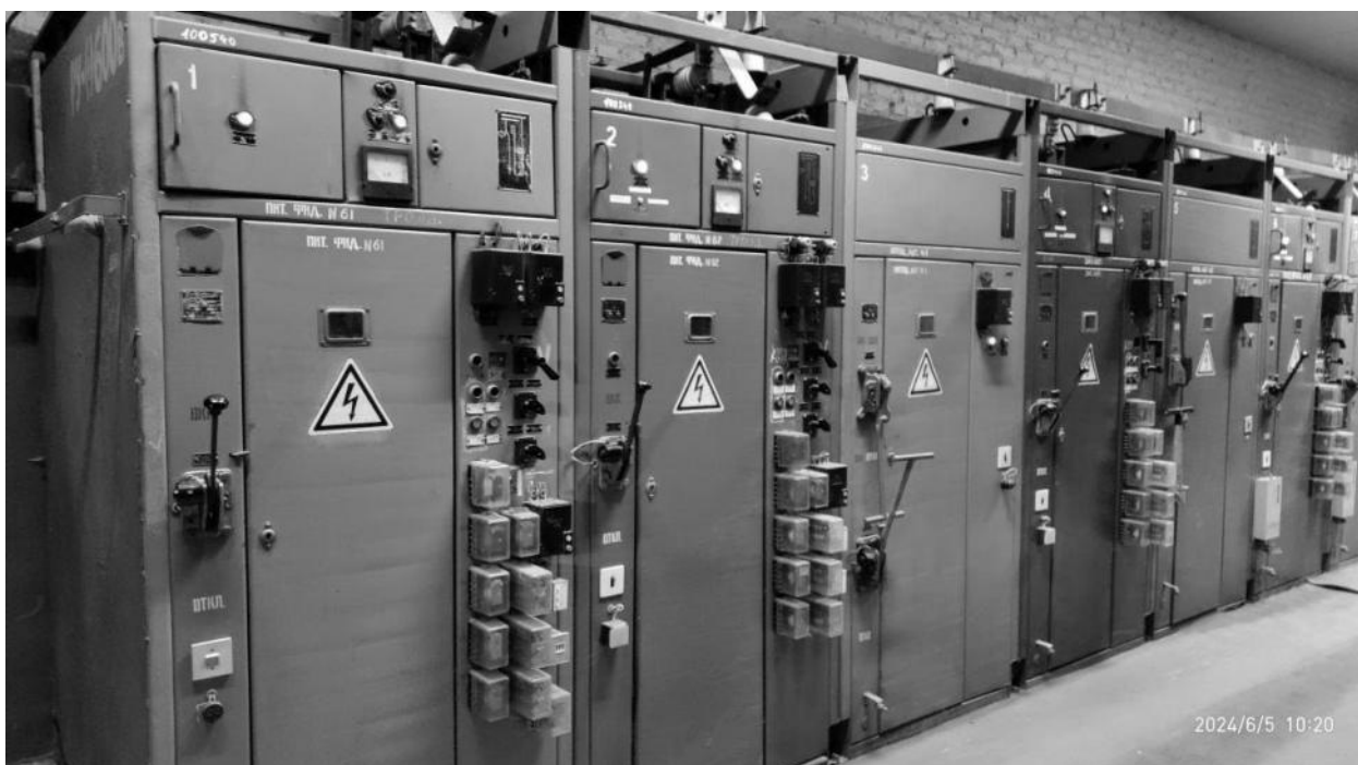
Рисунок 2.236 – Распределительные устройства РУ «+» 600 В (СЭМЗ) на ТП-6
