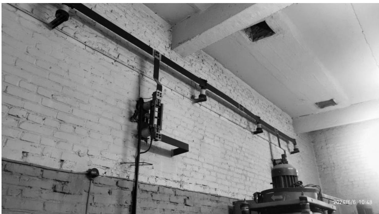
Рисунок 2.188 – Внутренний вид ТП-4
