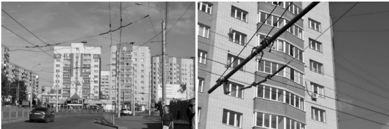
Рисунок 2.565 – Контактный провод троллейбуса
