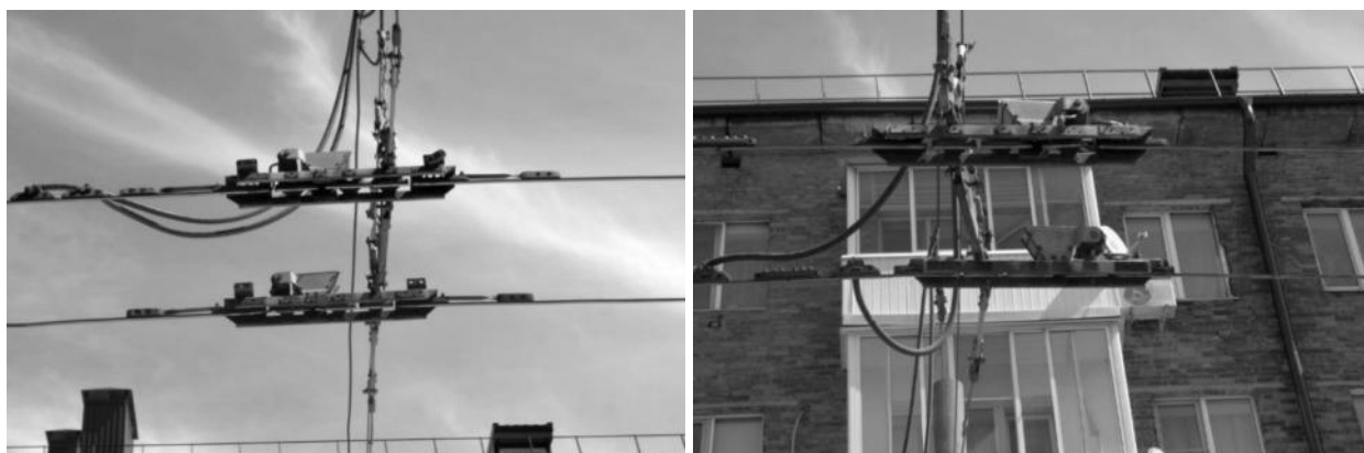
Рисунок 2.500 – Секционные изоляторы на участке контактной сети
