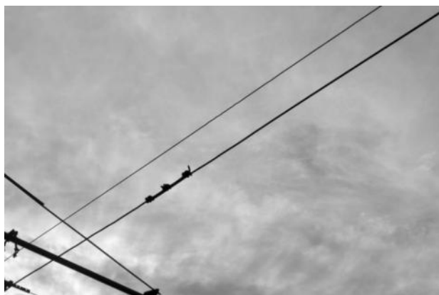
Рисунок 2.326 – Контактный провод трамвая
