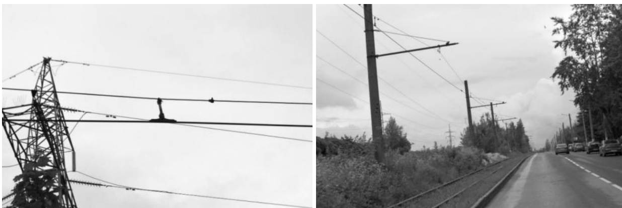
Рисунок 2.440 – Контактный провод трамвая
