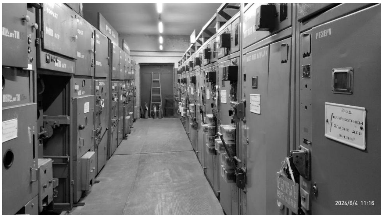
Рисунок 2.175 – Внутренний вид ТП-1
