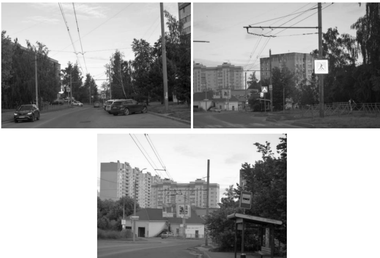
Рисунок 2.589 – Контактный провод троллейбуса
