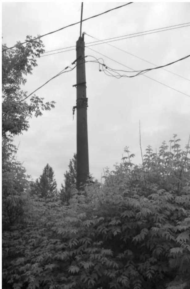
Рисунок 2.388 – Железобетонная опора контактной сети
