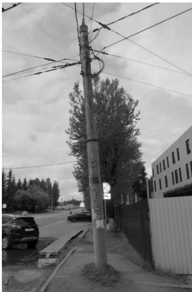
Рисунок 2.272 – Опора контактной сети
