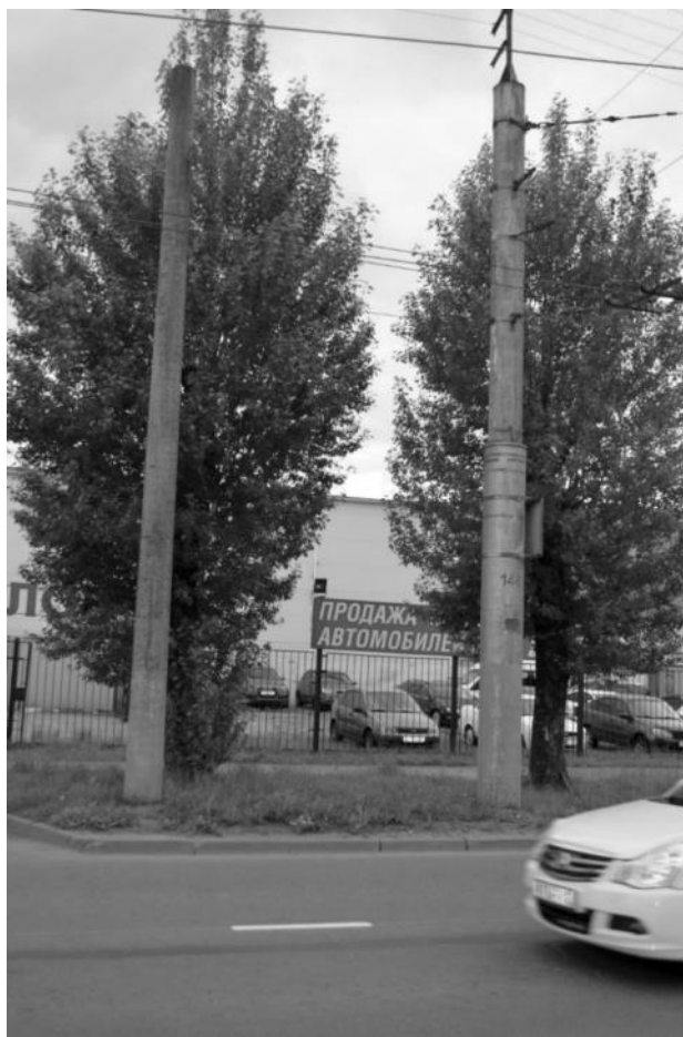
Рисунок 2.622 – Железобетонная опора контактной сети
