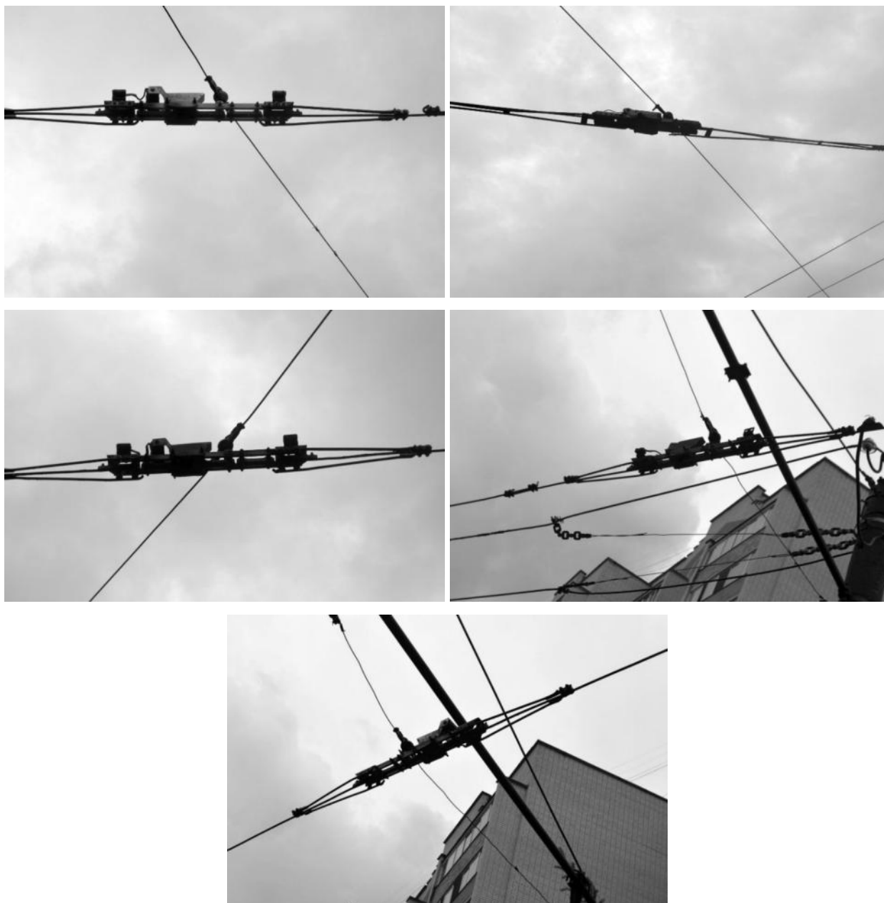
Рисунок 2.400 – Секционные изоляторы на участке контактной сети
