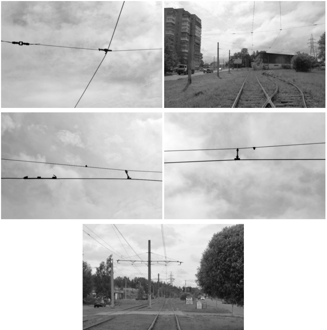
Рисунок 2.261 – Контактный провод троллейбуса
