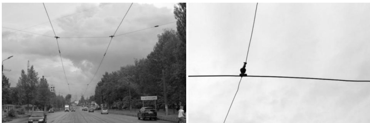
Рисунок 2.425 – Контактный провод трамвая
