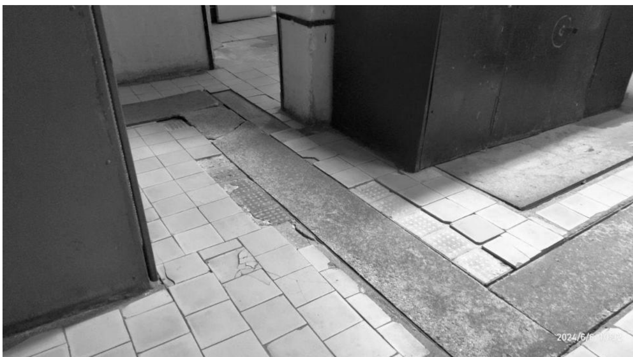
Рисунок 2.216 — Внутренний вид ТП-16
