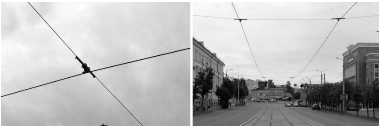
Рисунок 2.360 – Контактный провод трамвая
