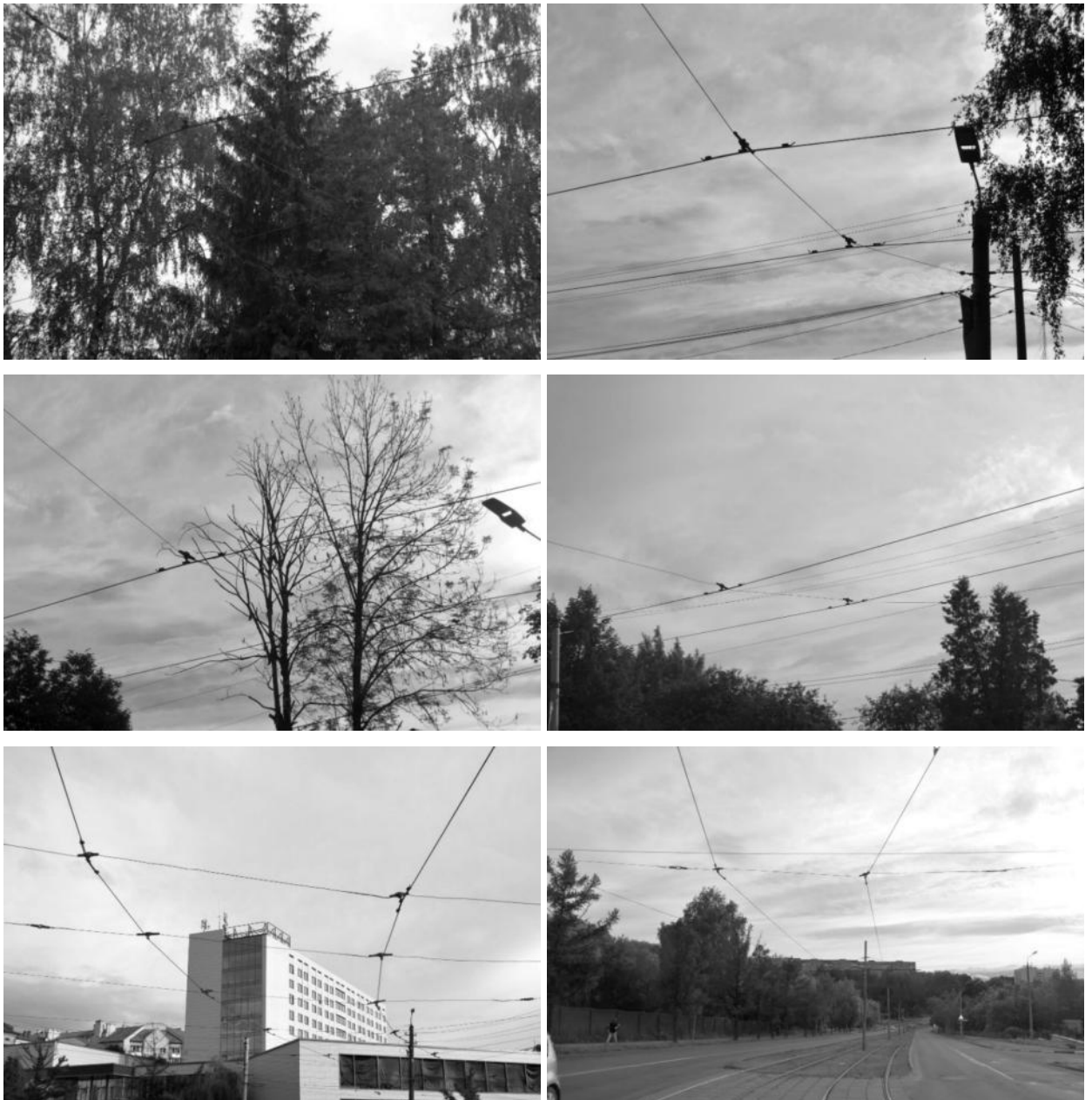
Рисунок 2.320 – Контактный провод трамвая
