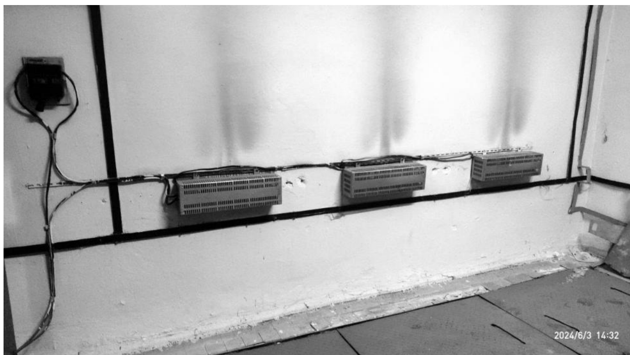
Рисунок 2.210 – Внутренний вид ТП-15
