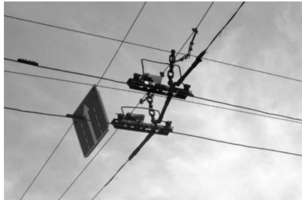
Рисунок 2.501 – Секционные изоляторы на участке контактной сети
