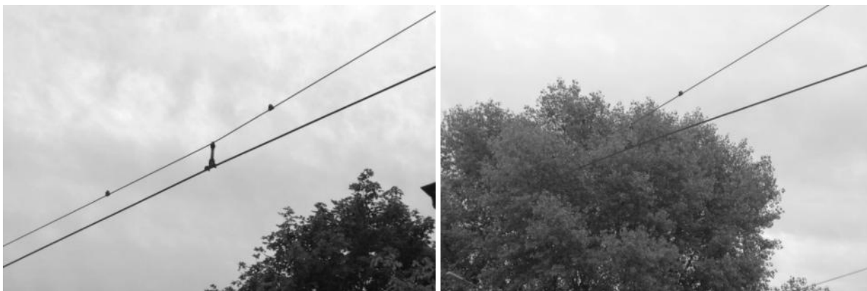
Рисунок 2.354 – Контактный провод трамвая
