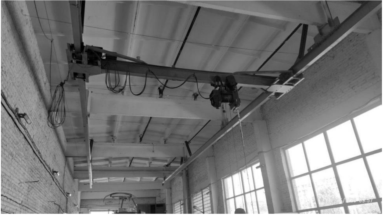
Рисунок 2.121 – Депо №2. Участок планового ремонта. Подъемно-транспортное оборудование
