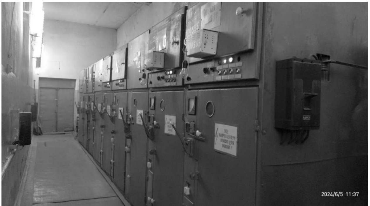
Рисунок 2.201 – Внутренний вид ТП-7
