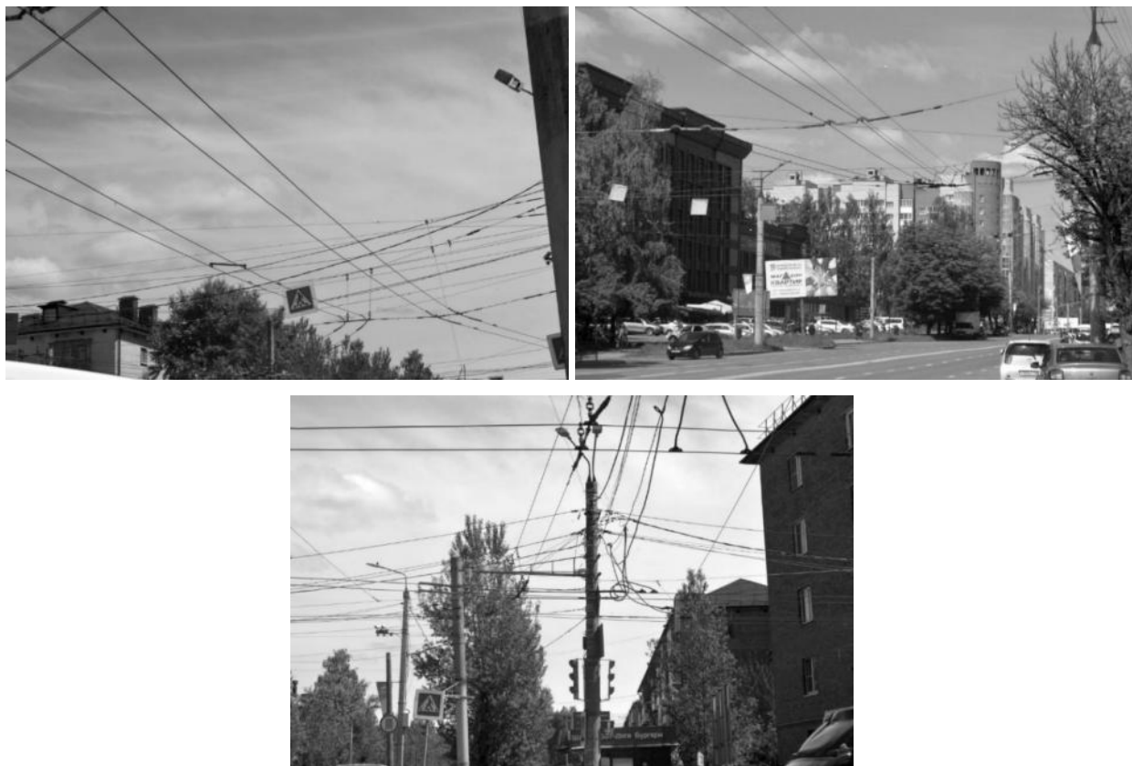
Рисунок 2.499 – Контактный провод троллейбуса
