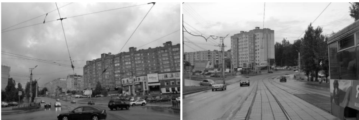
Рисунок 2.408 – Контактный провод трамвая
