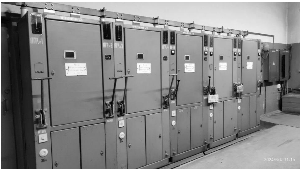
Рисунок 2.242 – Распределительное устройство отрицательной шины (СЭМЗ) на ТП-1
