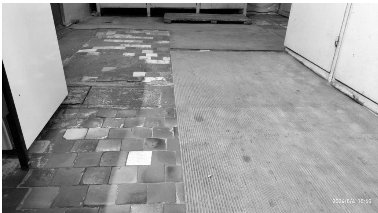
Рисунок 2.206 – Внутренний вид ТП-8
