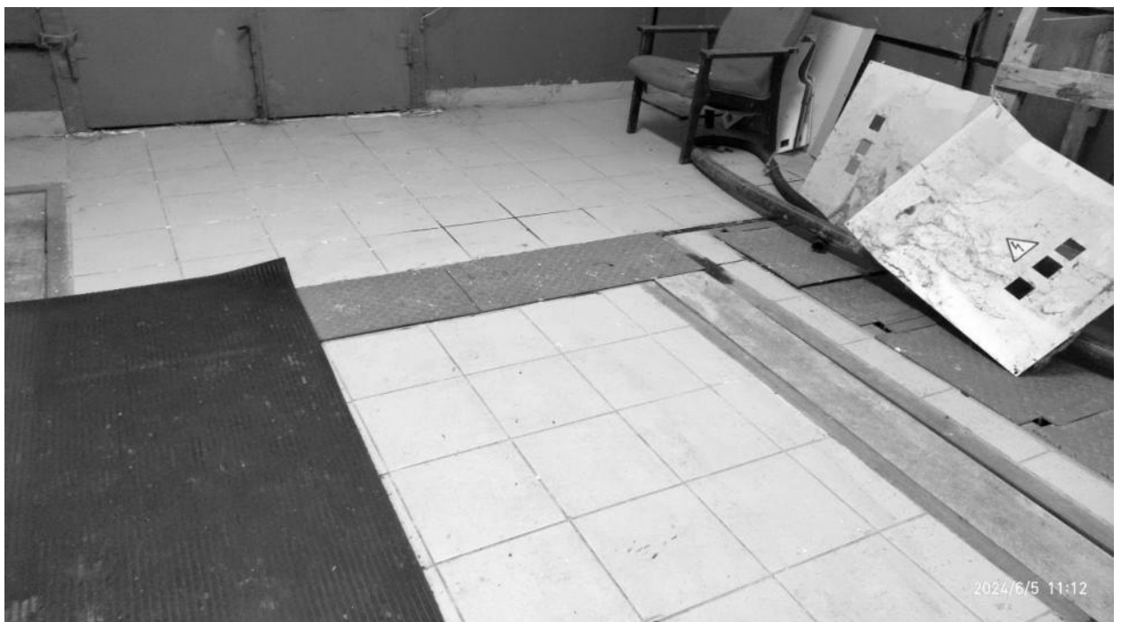
Рисунок 2.220 – Внутренний вид ТП-18
