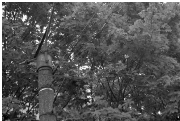
Рисунок 2.376 – Контактный провод трамвая
