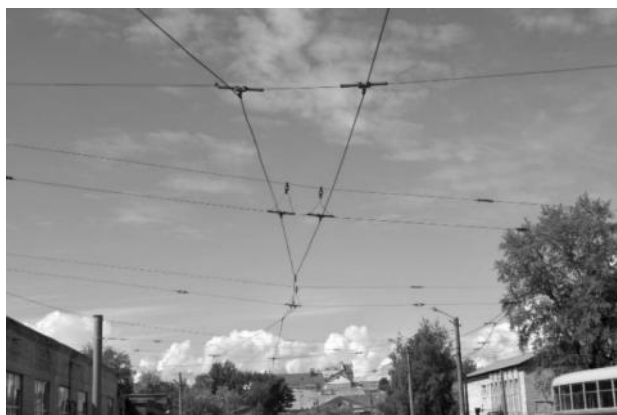
Рисунок 2.480 – Участок контактной сети
