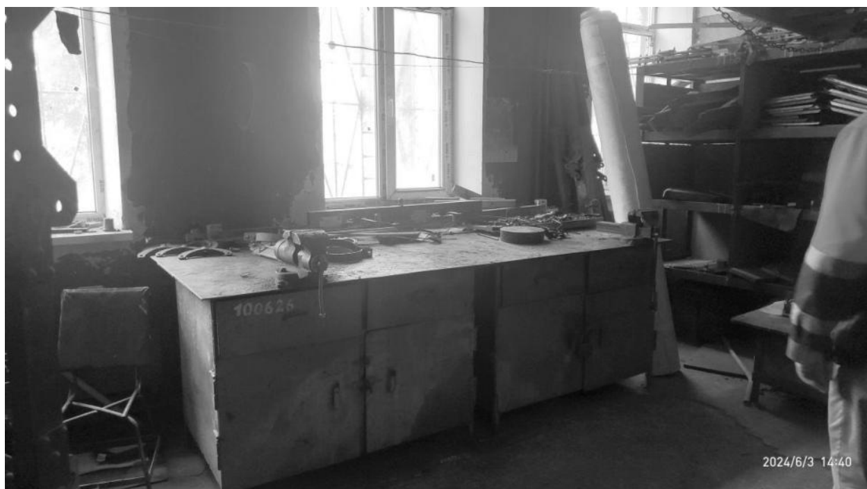
Рисунок 2.212 – Внутренний вид ТП-15
