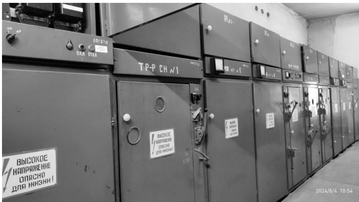
Рисунок 2.232 Камеры РУ-6 кВ типа КВВО-2 с выкатными тележками на ТП-8
