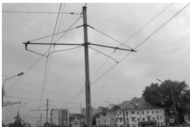
Рисунок 2.393 – Перемычка выполненная из изолированного электрического кабеля
