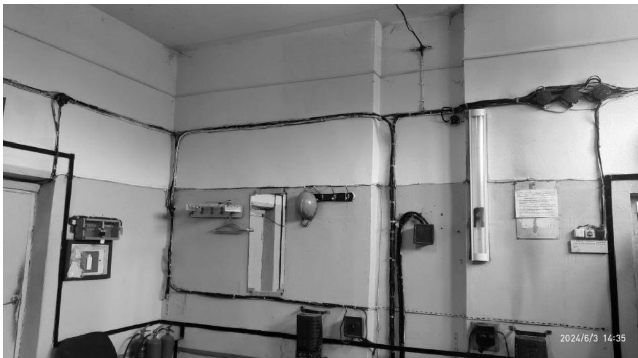
Рисунок 2.209 – Внутренний вид ТП-15
