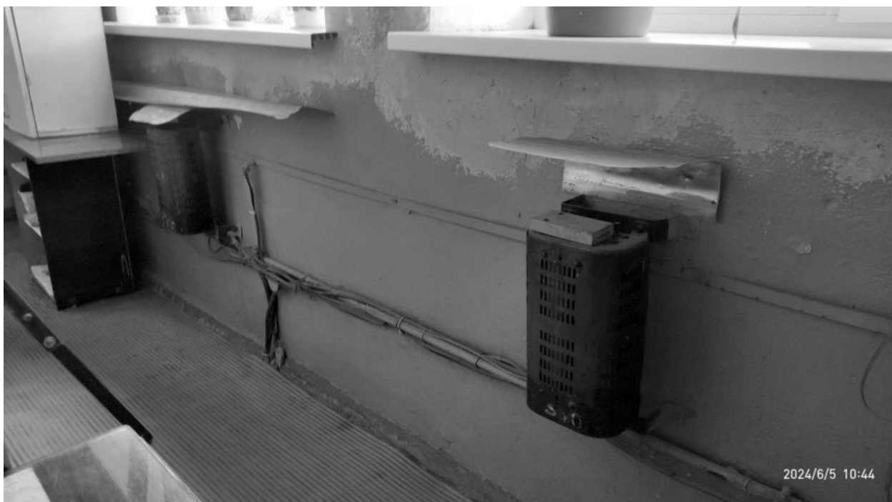
Рисунок 2.184 – Внутренний вид ТП-3
