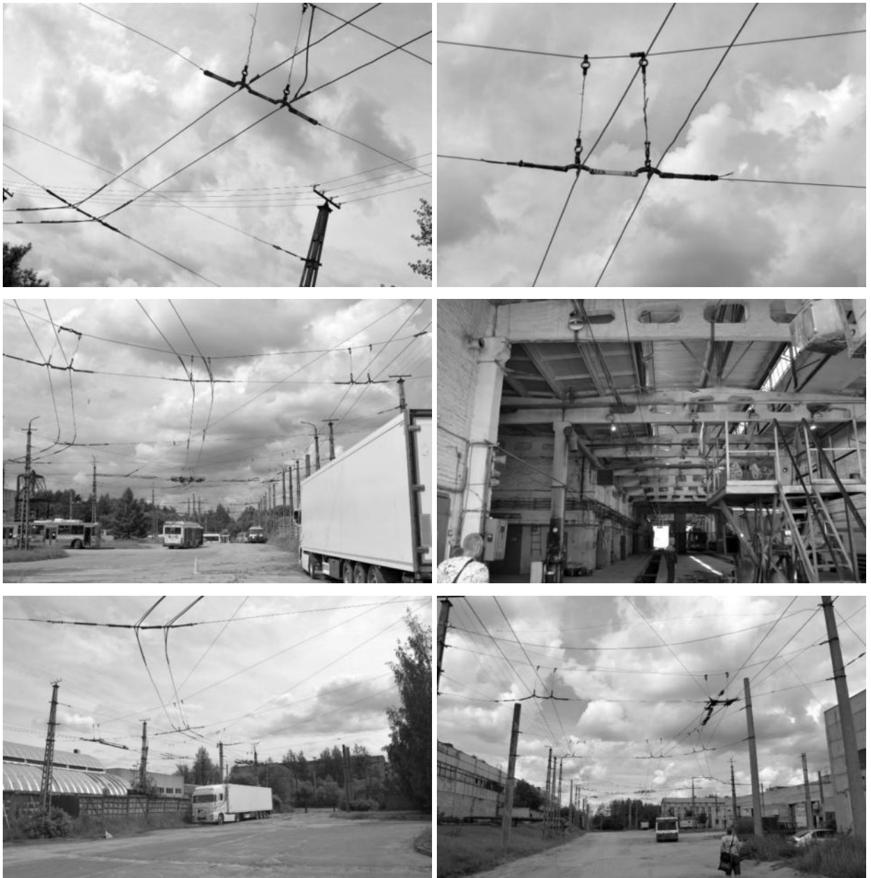
Рисунок 2.631 – Контактный провод троллейбуса
