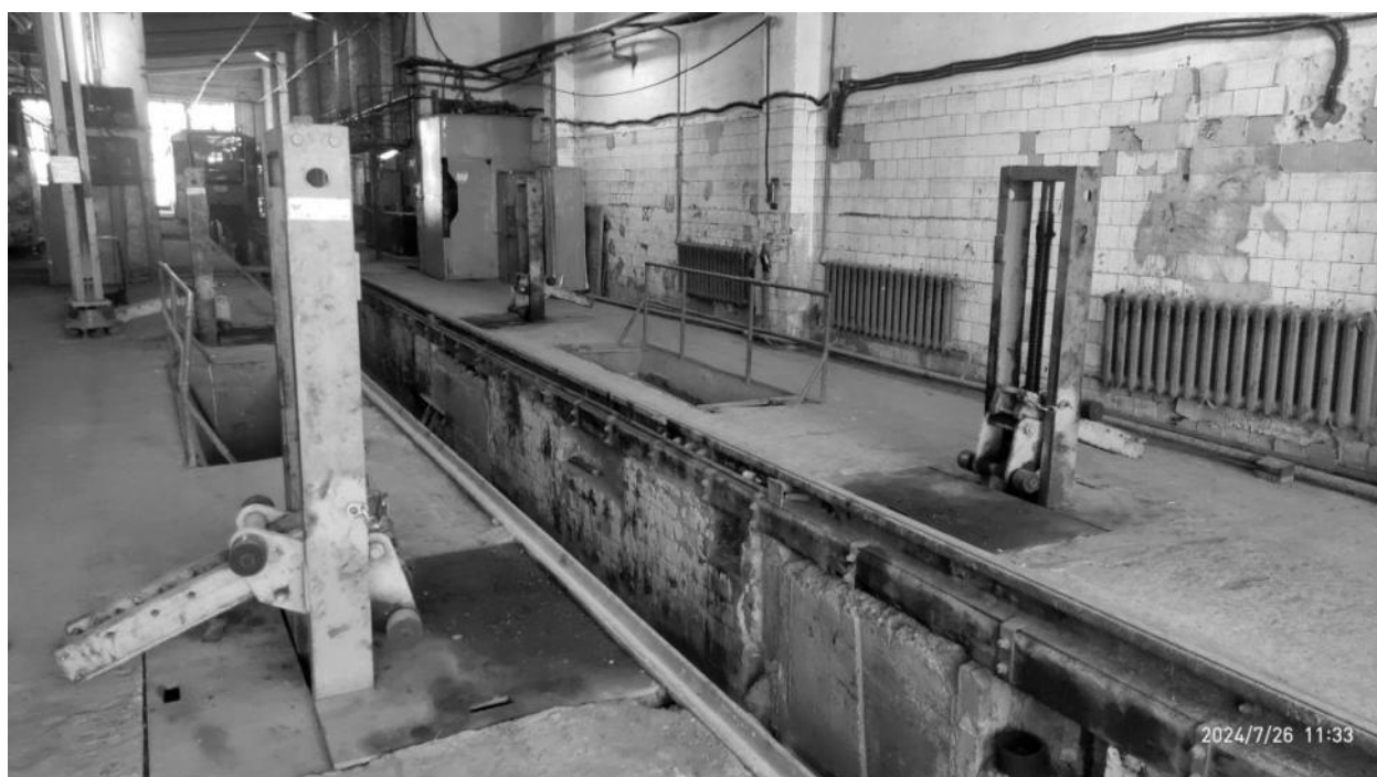
Рисунок 2.112 – Депо №1. Подъемно-транспортное оборудование
