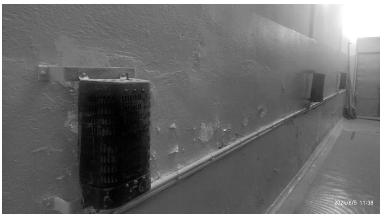
Рисунок 2.202 – Внутренний вид ТП-7
