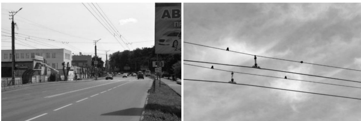
Рисунок 2.488 – Контактный провод троллейбуса
