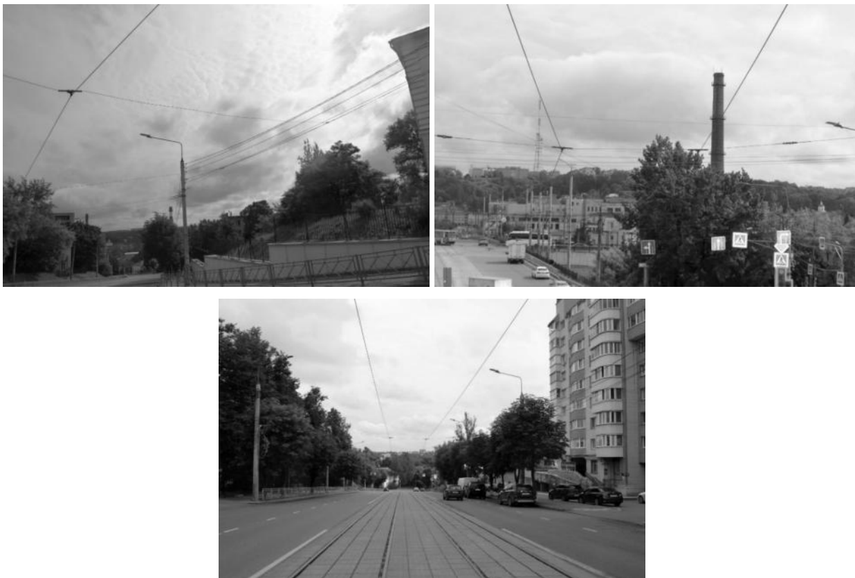
Рисунок 2.286 – Контактный провод трамвая
