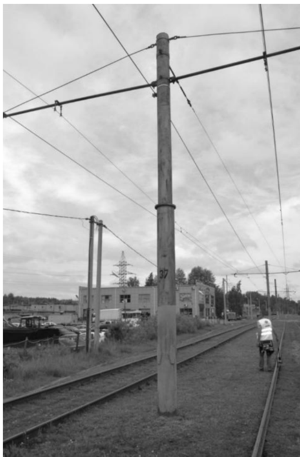
Рисунок 2.260 – Опора контактной сети
