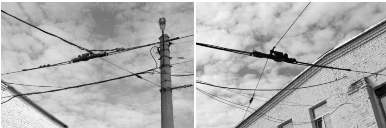
Рисунок 2.483 – Секционные изоляторы на участке контактной сети
