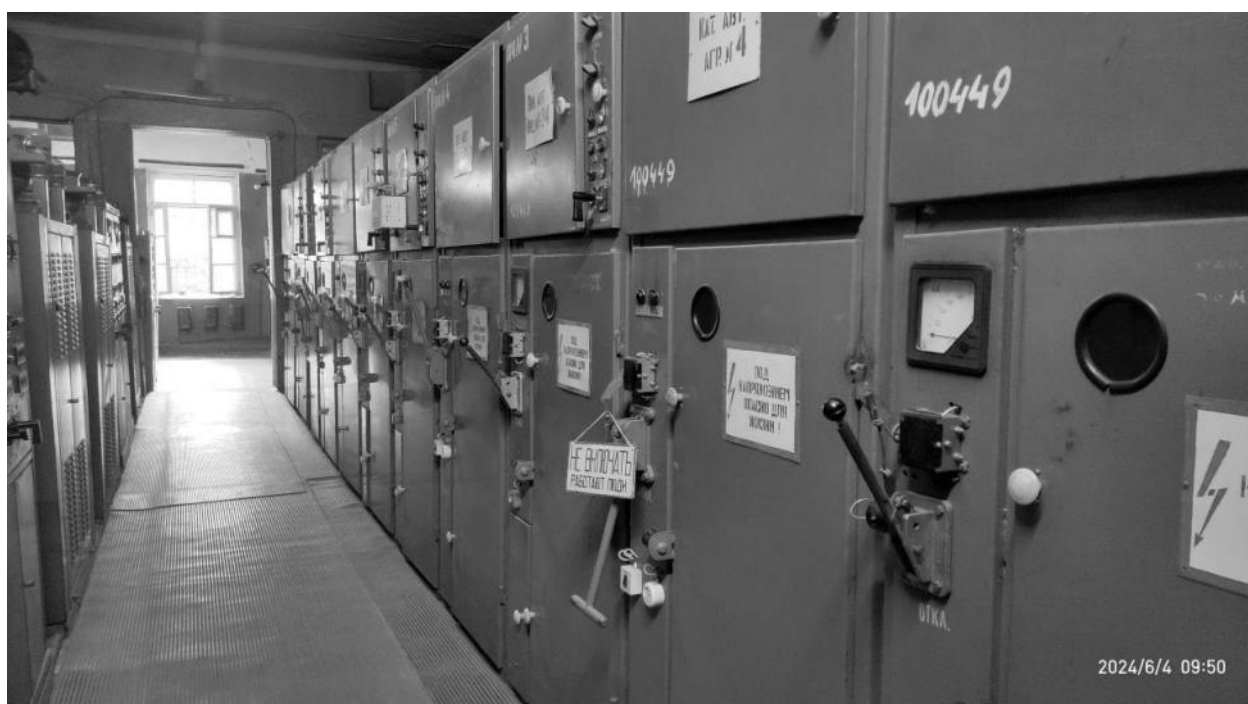
Рисунок 2.179 – Внутренний вид ТП-2
