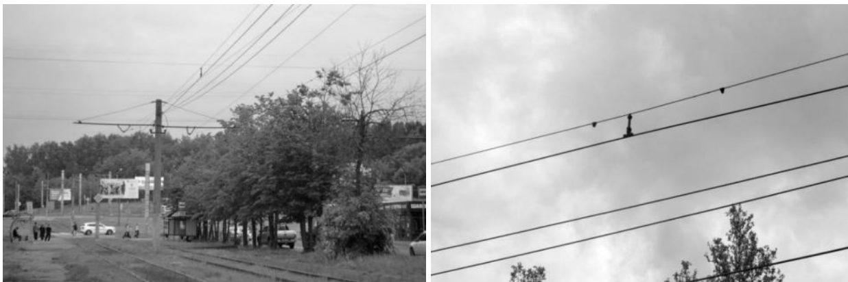
Рисунок 2.463 – Контактный провод трамвая
