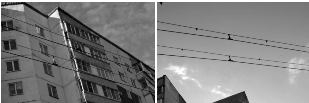
Рисунок 2.572 – Контактный провод троллейбуса
