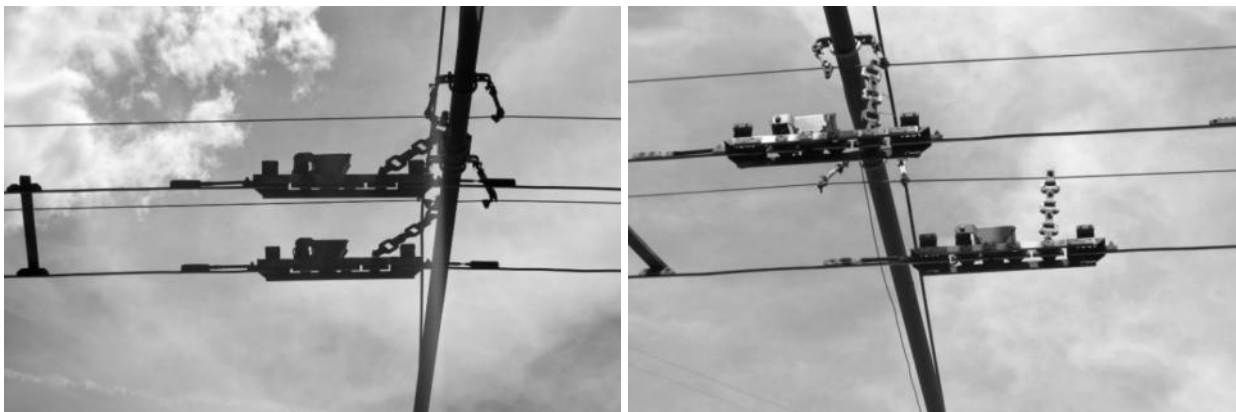
Рисунок 2.516 – Секционные изоляторы на участке контактной сети
