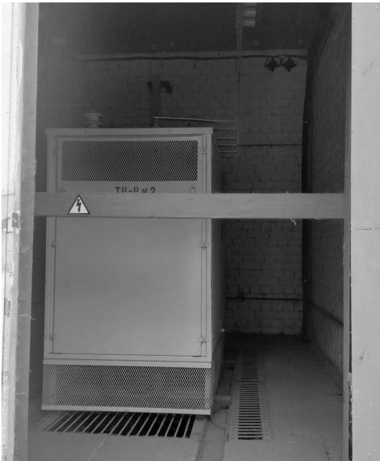
Рисунок 2.223 – Камера трансформатора ТСЗПУ-1000/10ГТ на ТП-18
