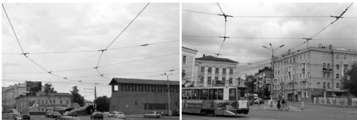
Рисунок 2.366 – Контактный провод трамвая
