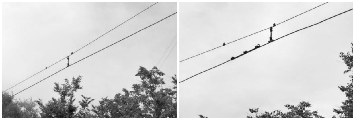
Рисунок 2.341 – Контактный провод трамвая
