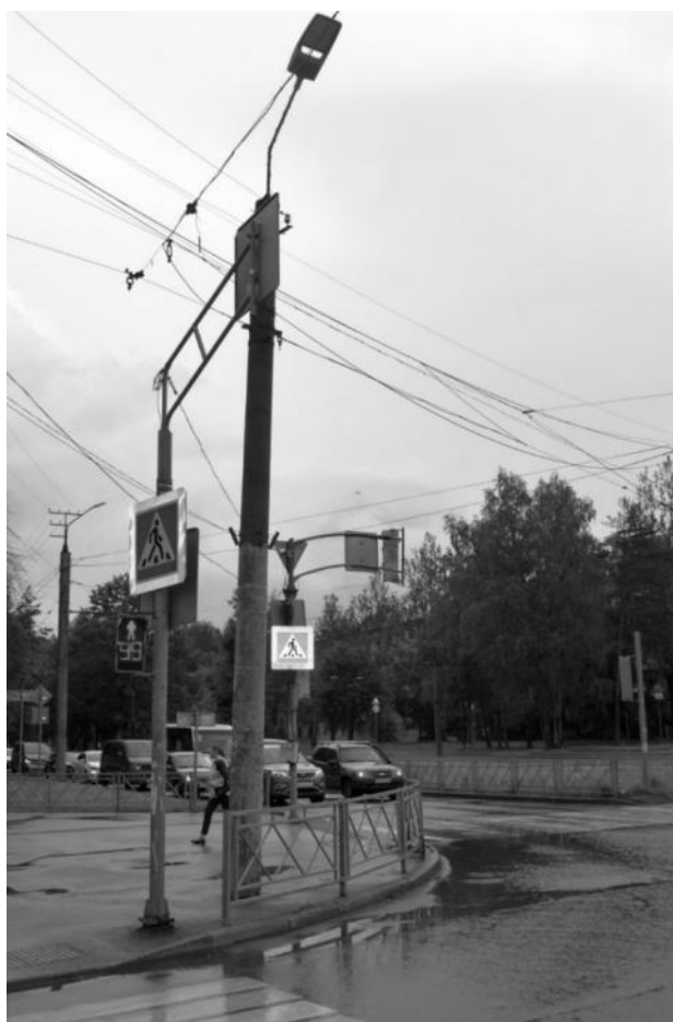
Рисунок 2.424 – Железобетонная опора контактной сети
