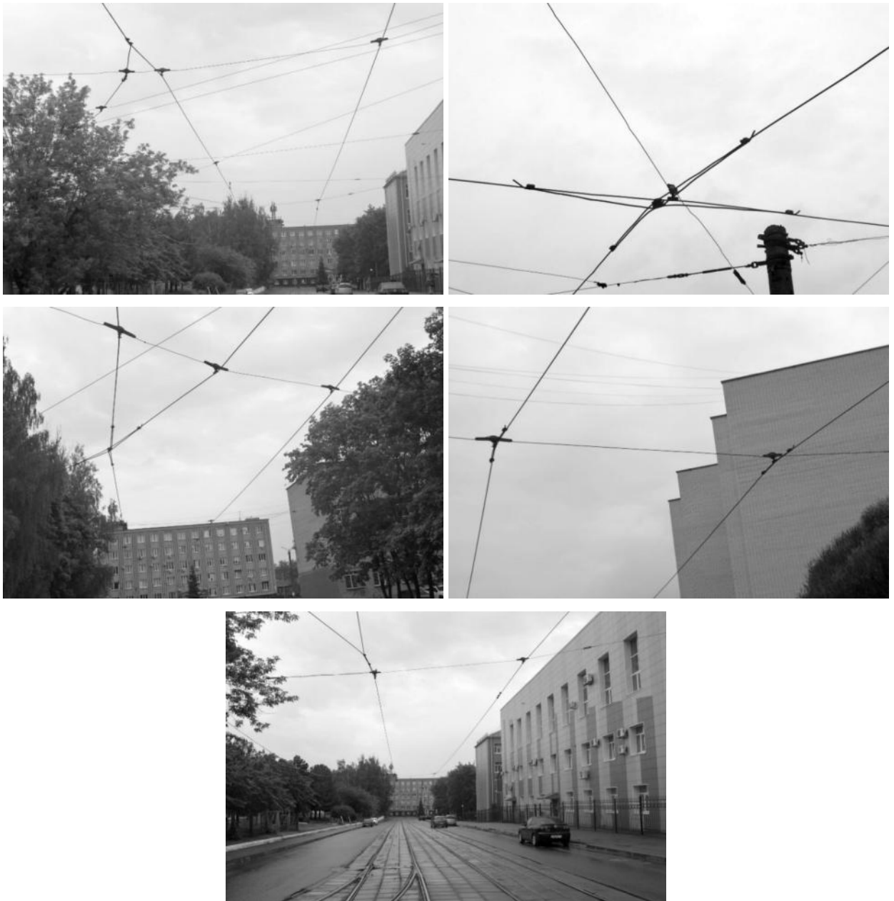
Рисунок 2.398 – Контактный провод трамвая
