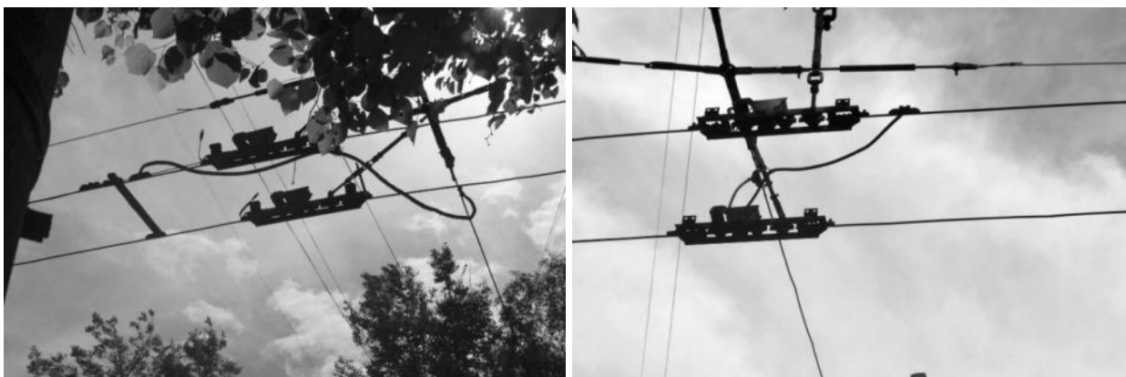
Рисунок 2.538 – Секционные изоляторы на участке контактной сети
