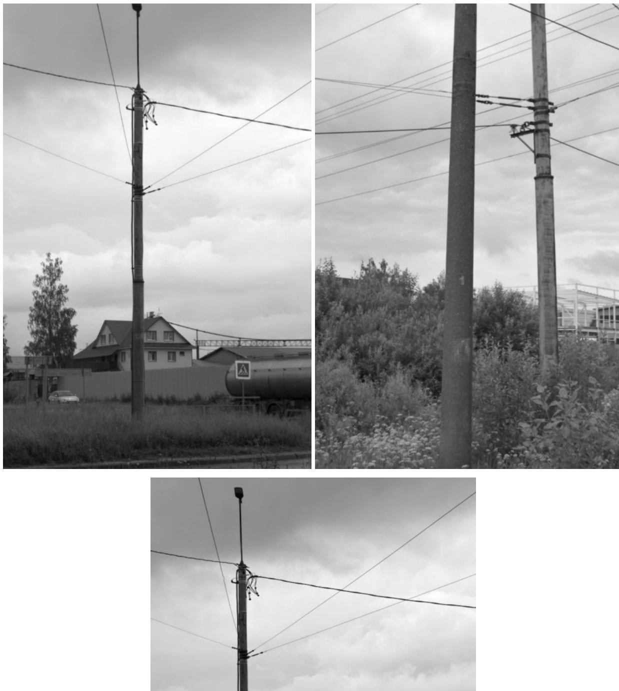
Рисунок 2.446 – Металлические опоры контактной сети
