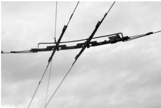
Рисунок 2.459 – Пересечение контактных проводов трамвая и троллейбус
