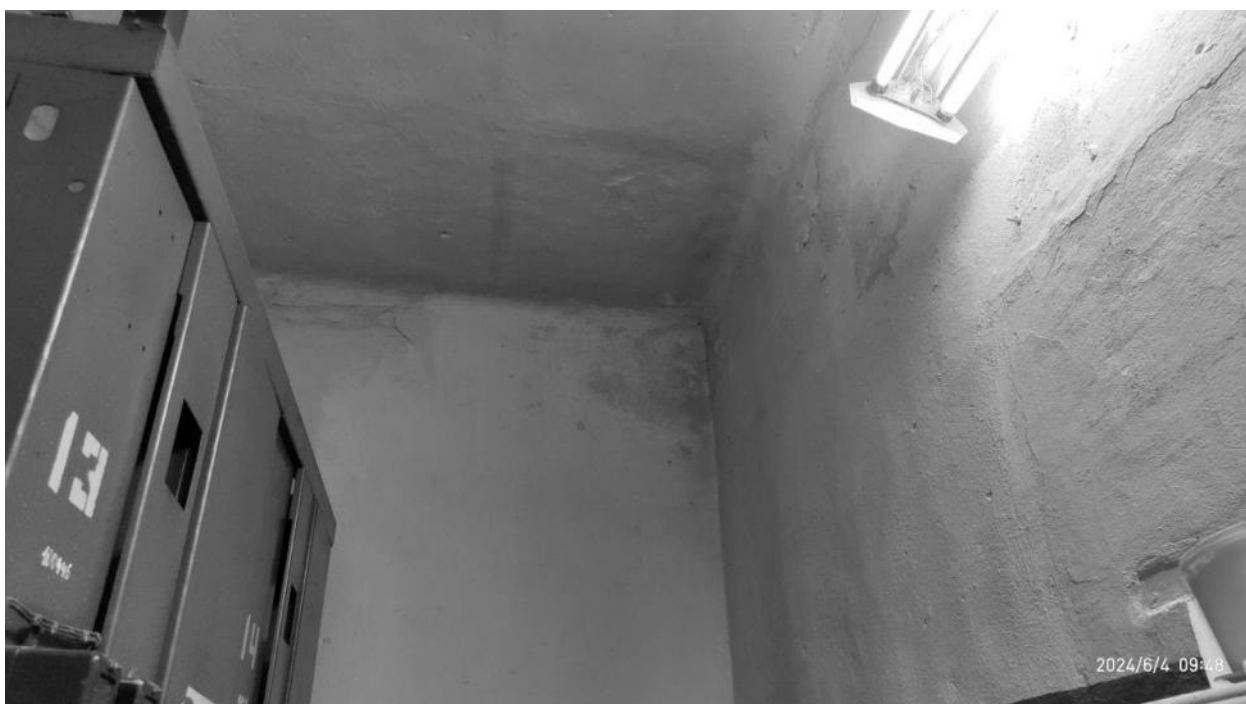
Рисунок 2.180 – Внутренний вид ТП-2
