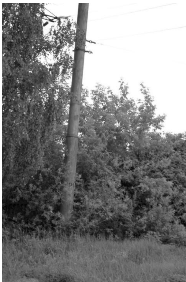
Рисунок 2.602 – Опора контактной сети
