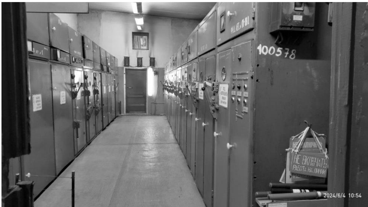
Рисунок 2.205 – Внутренний вид ТП-8
