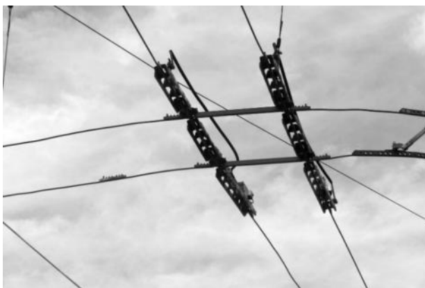
Рисунок 2.599 – Пересечения контактных проводов троллейбуса
