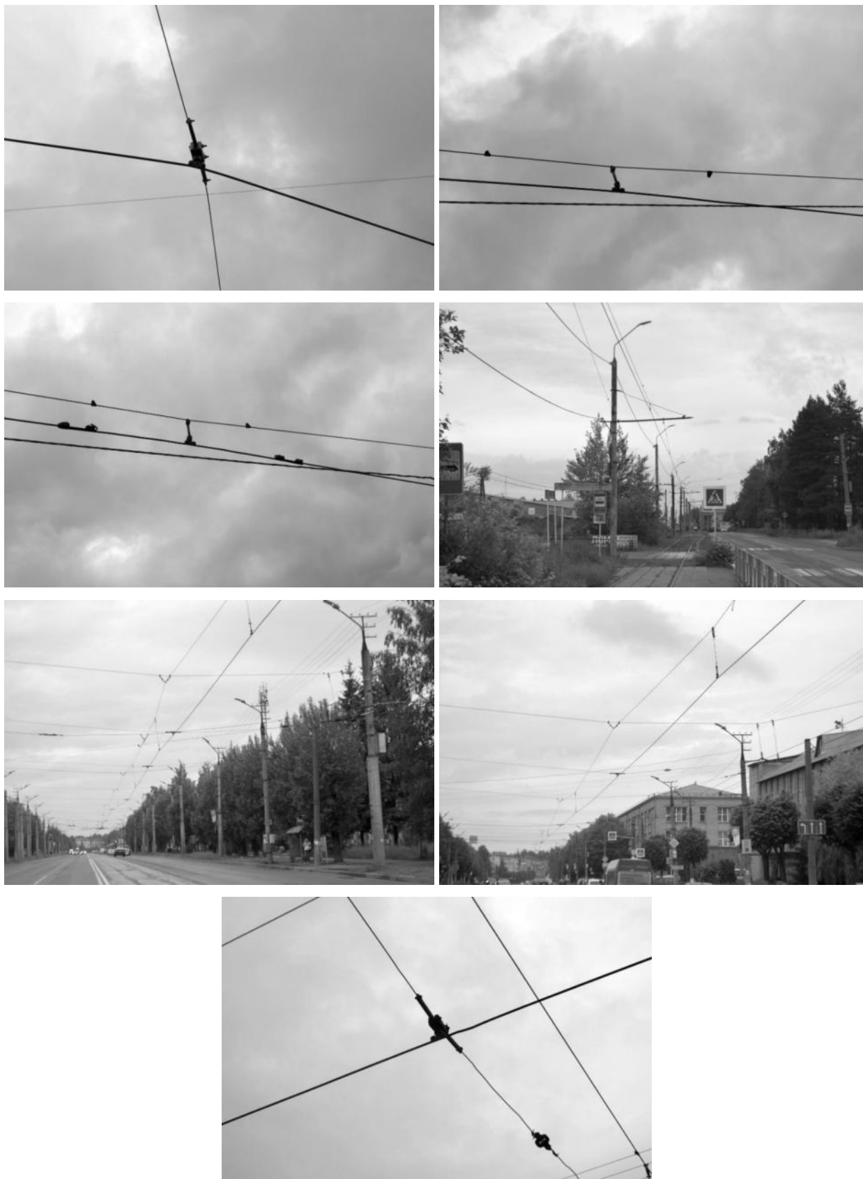
Рисунок 2.448 – Контактный провод трамвая
