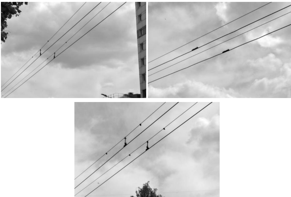
Рисунок 2.523 – Контактный провод троллейбуса
