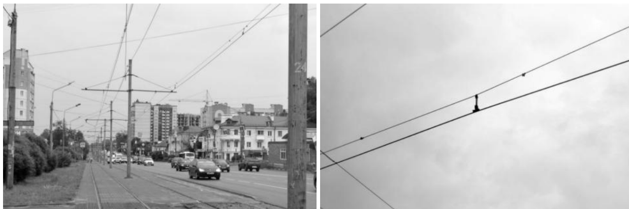
Рисунок 2.389 – Контактный провод трамвая
