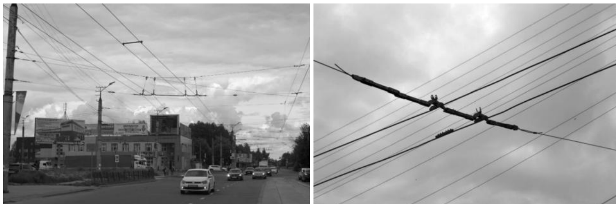
Рисунок 2.623 – Контактный провод троллейбуса
