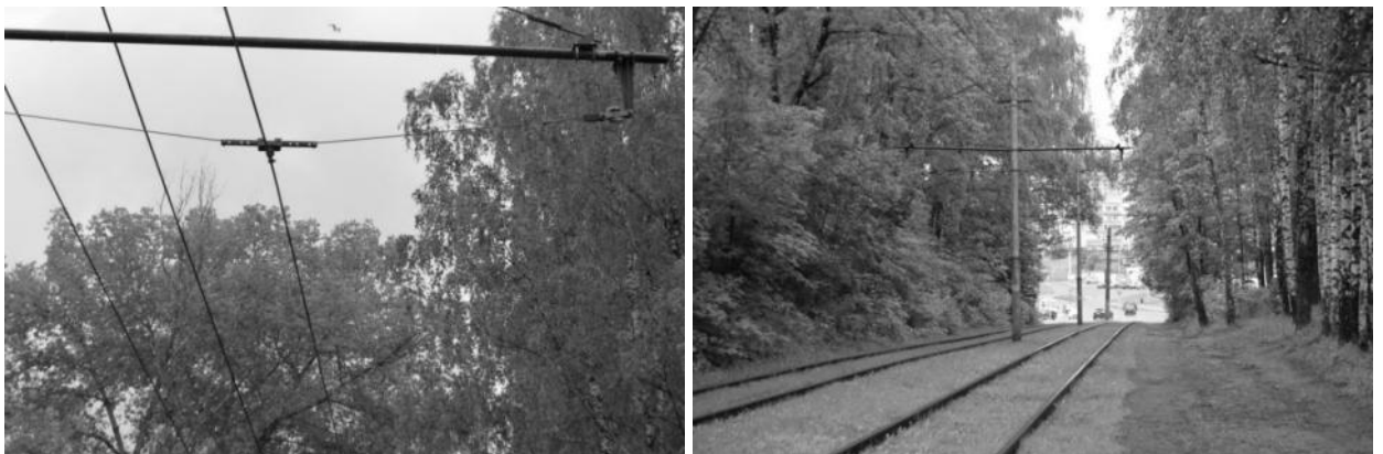
Рисунок 2.407 – Контактный провод трамвая
