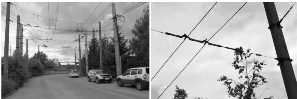
Рисунок 2.604 – Контактный провод троллейбуса
