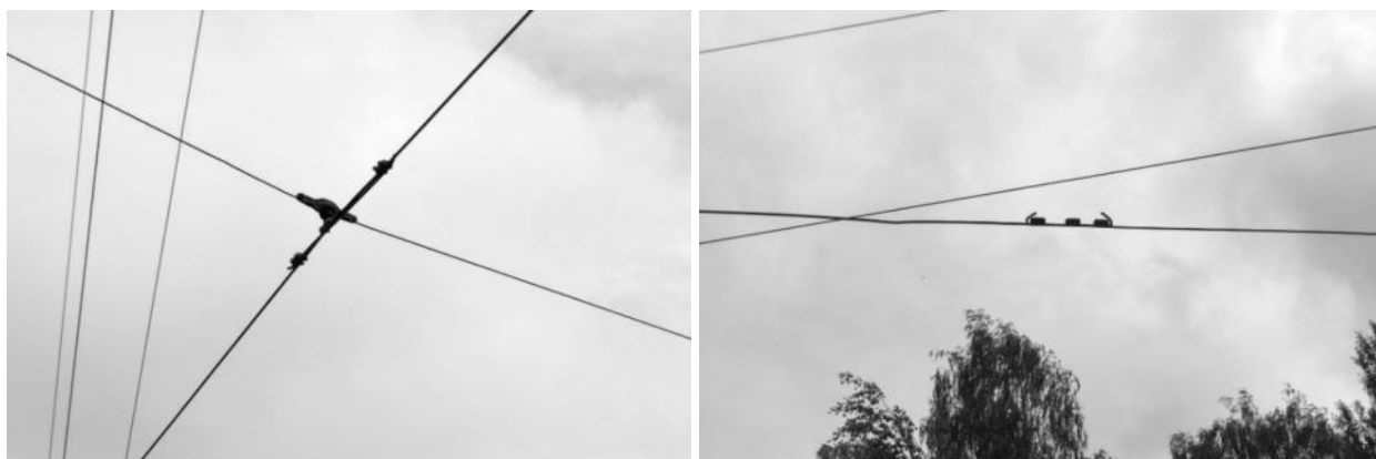
Рисунок 2.274– Контактный провод трамвая
