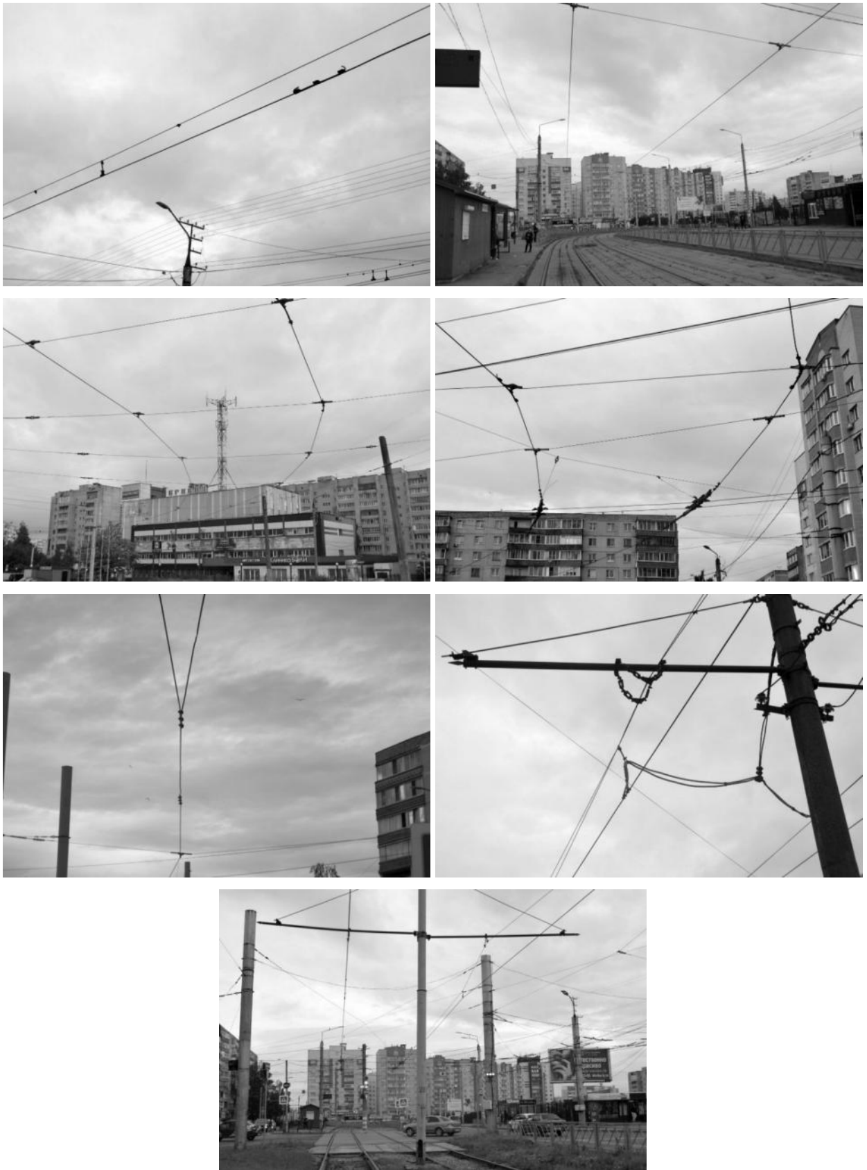
Рисунок 2.472 – Участок контактной сети
