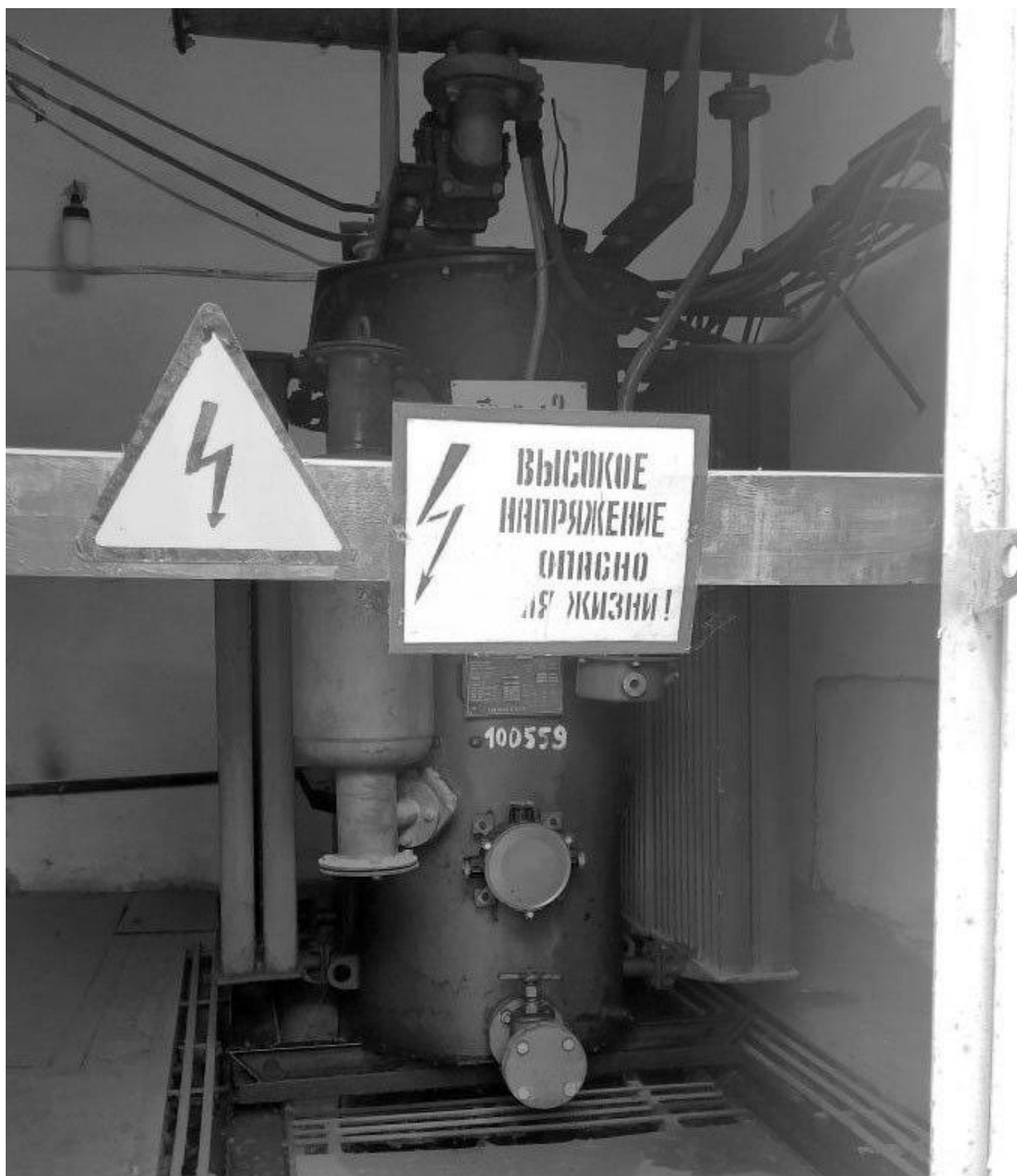
Рисунок 2.221 – Камера трансформатора ТМПУ-1000/10У2 на ТП-7
