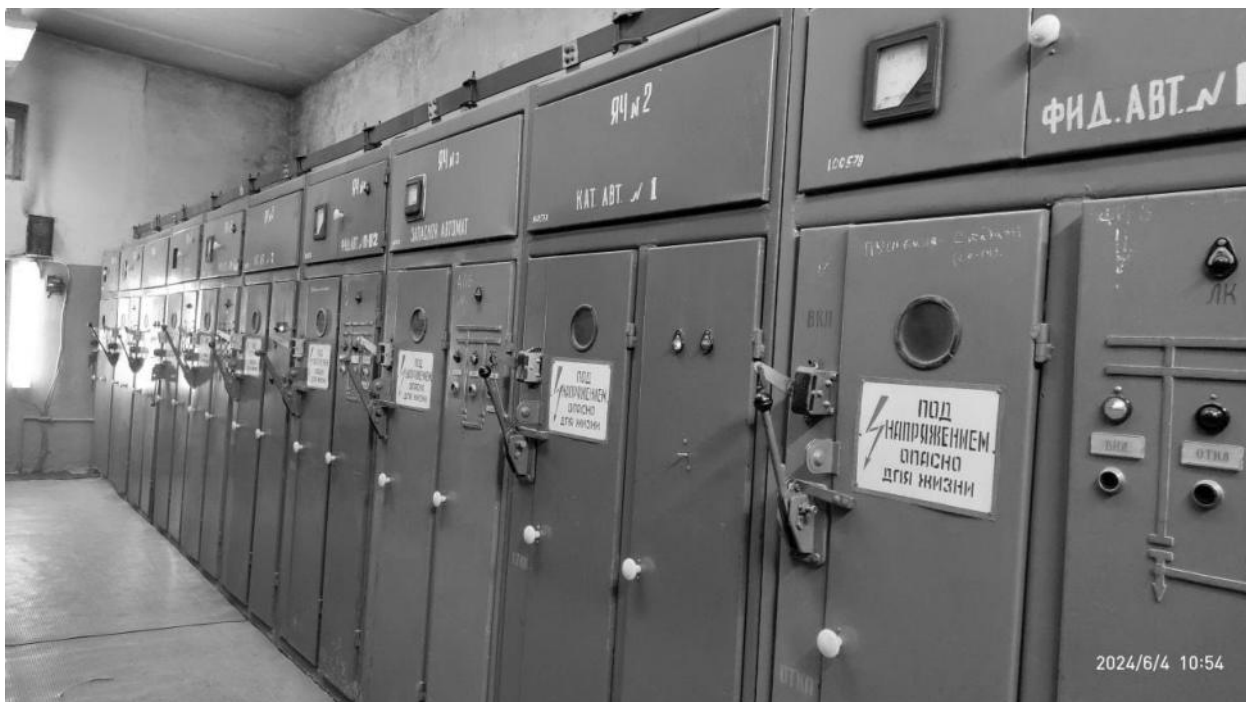
Рисунок 2.235 – Распределительные устройства РУ «+» 600 В (ЛЭМЗ) на ТП-8
