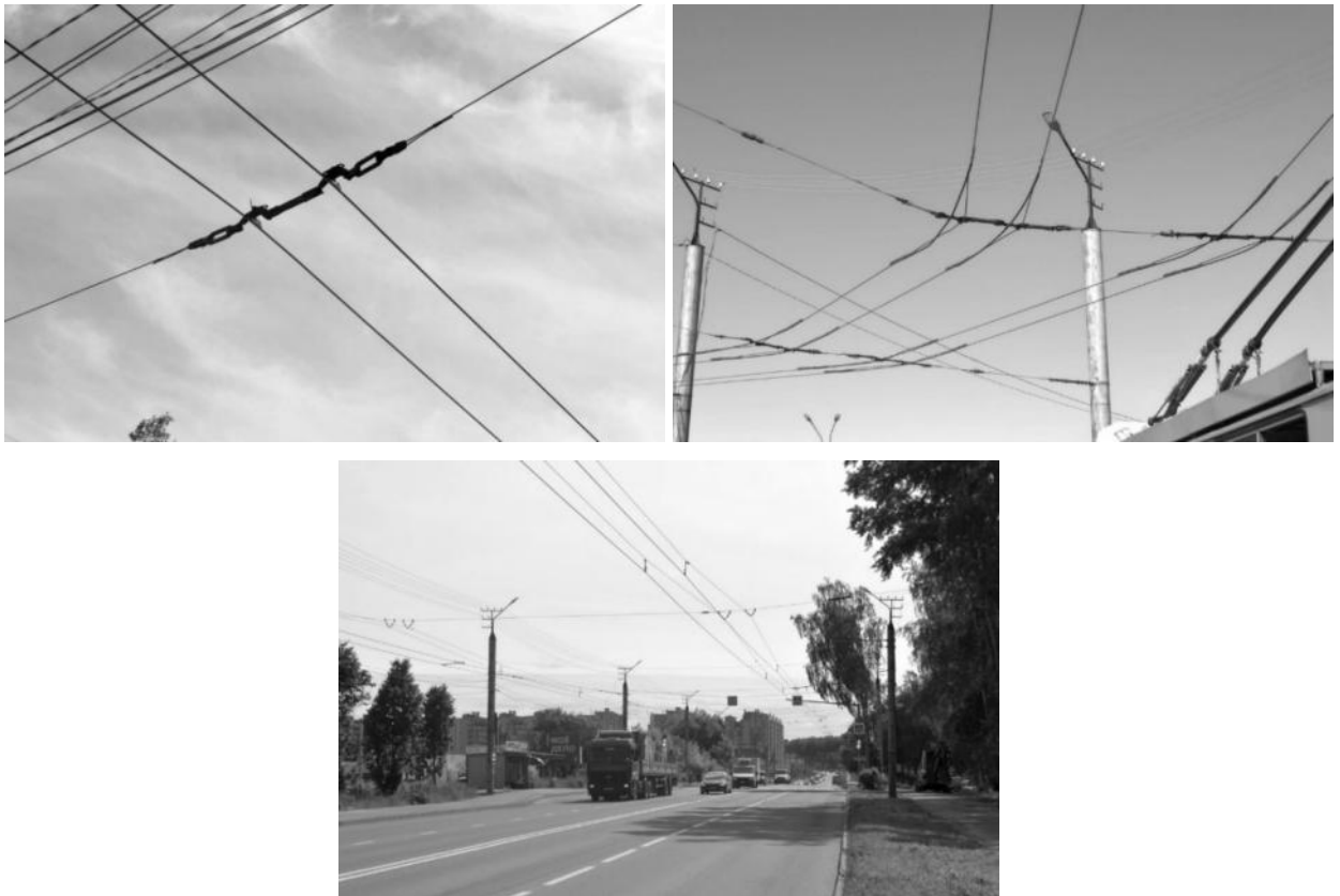
Рисунок 2.489 – Контактный провод троллейбуса
