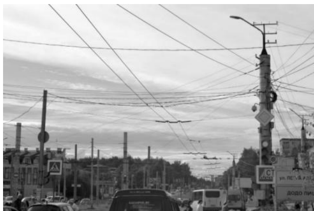
Рисунок 2.555 – Контактный провод троллейбуса
