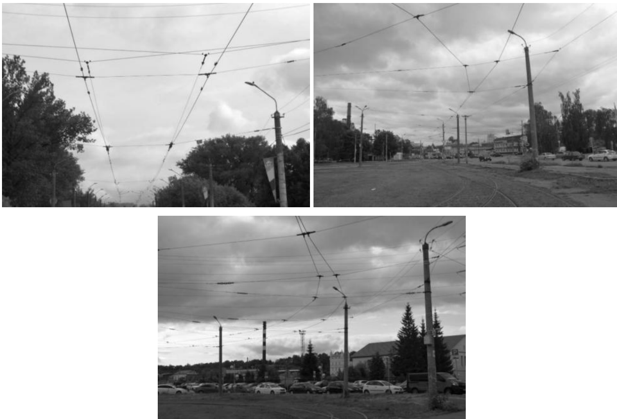
Рисунок 2.304 – Контактный провод трамвая
