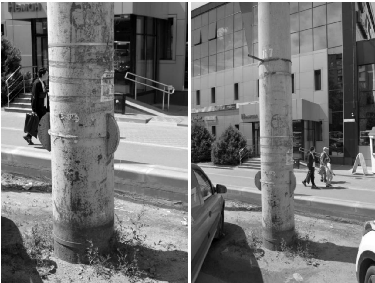
Рисунок 2.507 – Опора контактной сети
