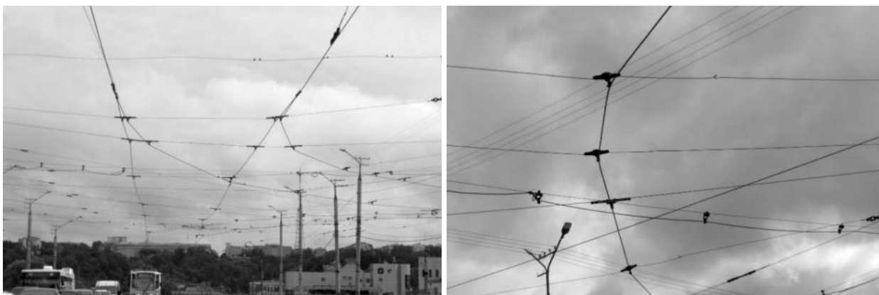
Рисунок 2.290 – Контактный провод трамвая
