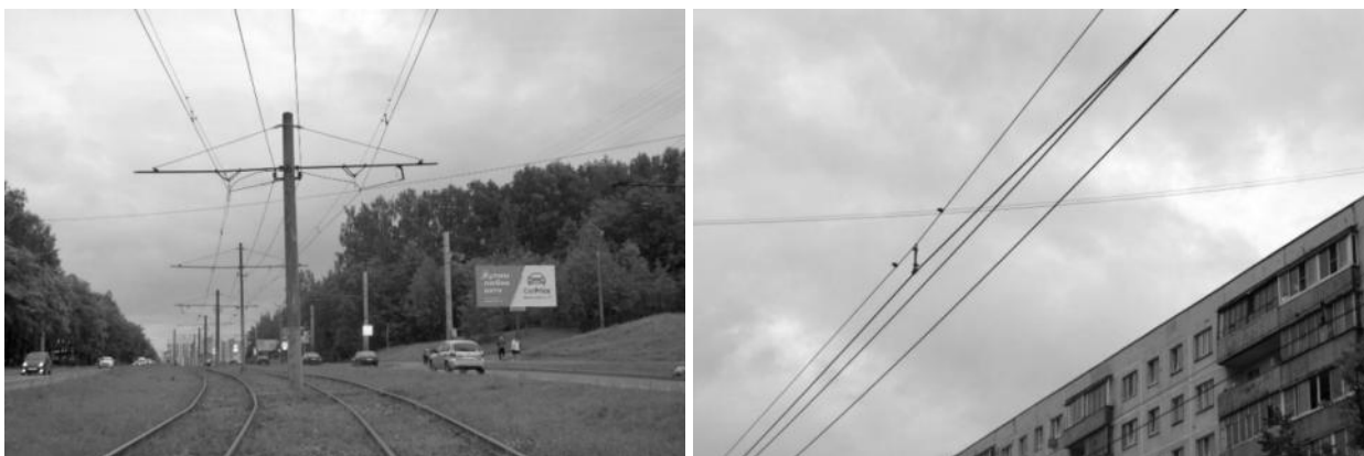
Рисунок 2.462 – Контактный провод трамвая
