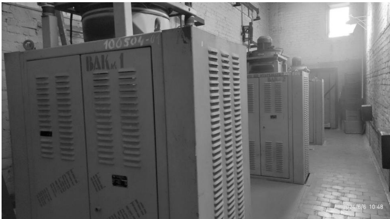
Рисунок 2.187 – Внутренний вид ТП-4
