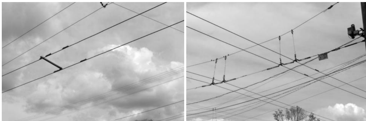
Рисунок 2.535 – Контактный провод троллейбуса
