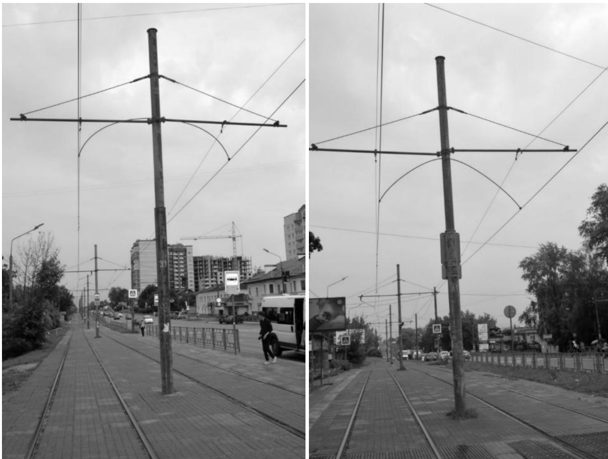
Рисунок 2.394 – Перемычка выполненная из изолированного электрического кабеля
