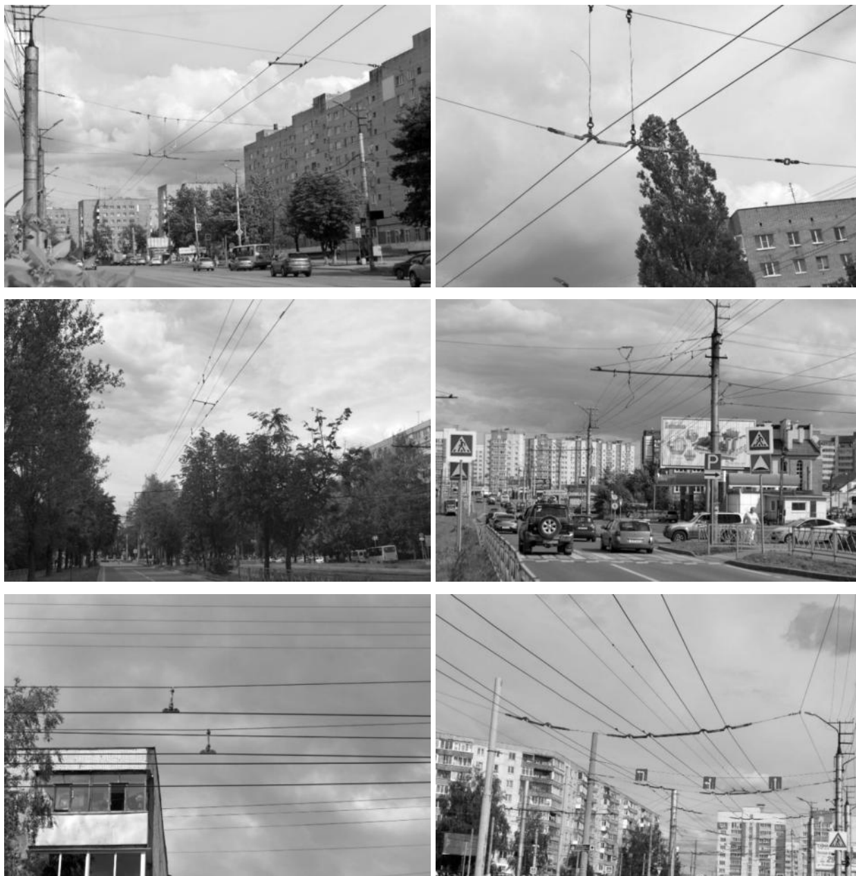
Рисунок 2.554 – Контактный провод троллейбуса
