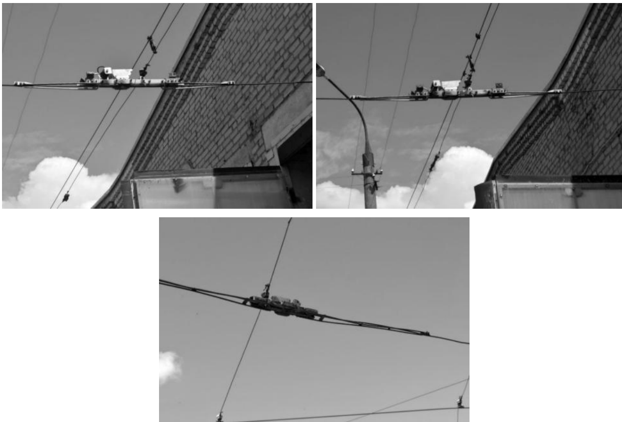
Рисунок 2.485 – Секционные изоляторы на участке контактной сети
