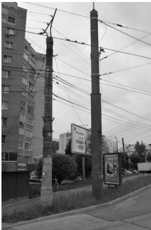
Рисунок 2.374 – Железобетонная опора контактной сети
