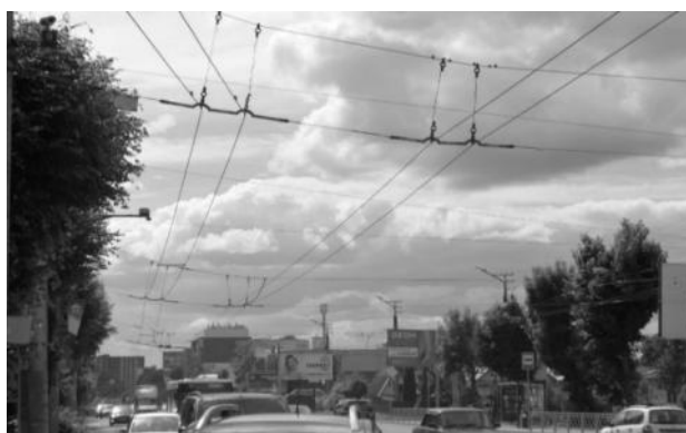
Рисунок 2.536 – Контактный провод троллейбуса
