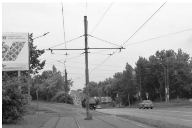
Рисунок 2.390 – Контактный провод трамвая
