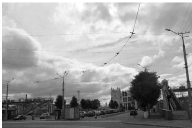
Рисунок 2.291 – Контактный провод трамвая
