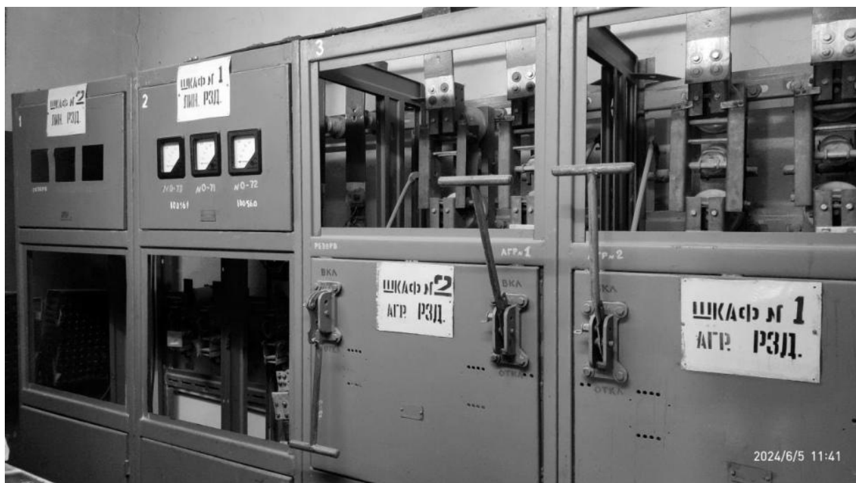
Рисунок 2.241 – Распределительное устройство отрицательной шины (ЛЭМЗ) на ТП-7
