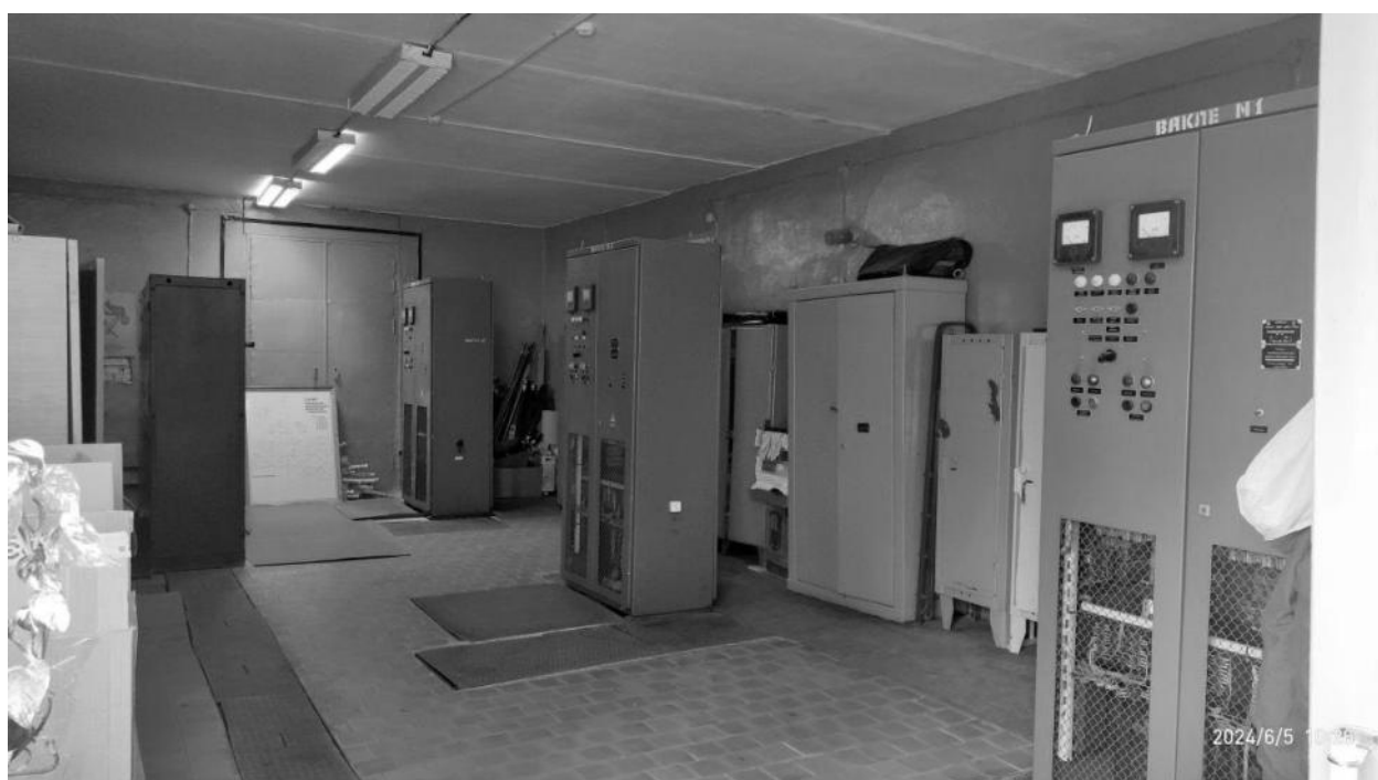
Рисунок 2.197 – Внутренний вид ТП-6
