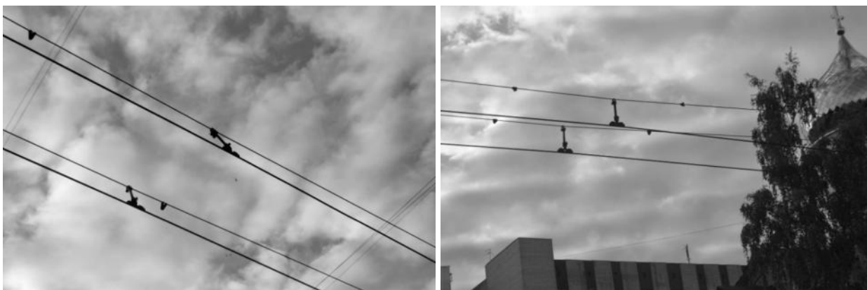
Рисунок 2.588 – Контактный провод троллейбуса
