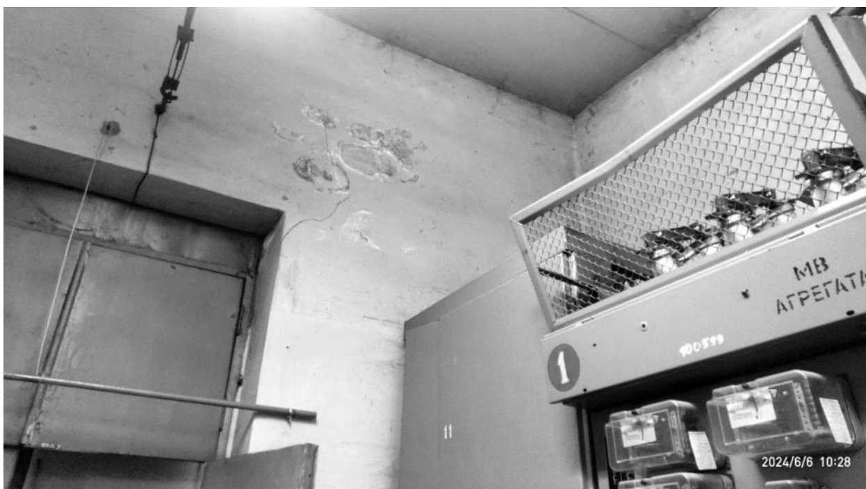
Рисунок 2.215 – Внутренний вид ТП-16
