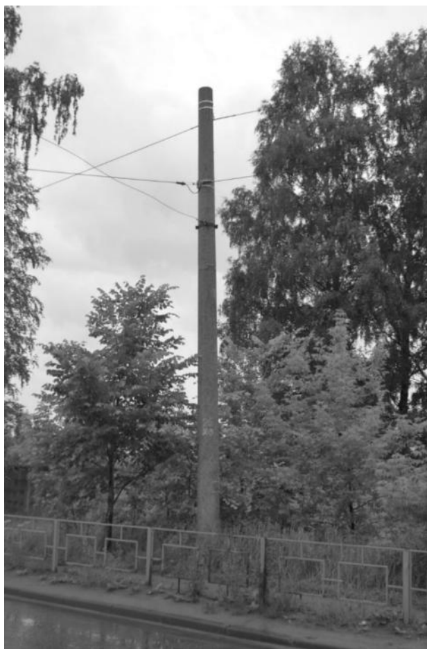
Рисунок 2.447 – Железобетонные опоры контактной сети
