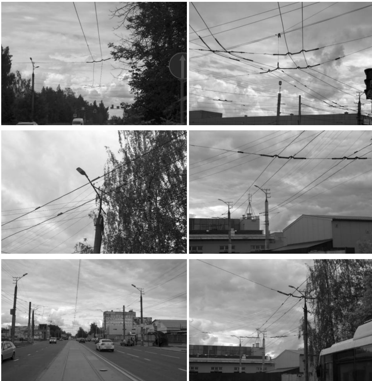
Рисунок 2.624 – Контактный провод троллейбуса
