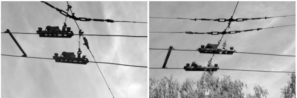
Рисунок 2.490 – Секционные изоляторы на участке контактной сети
