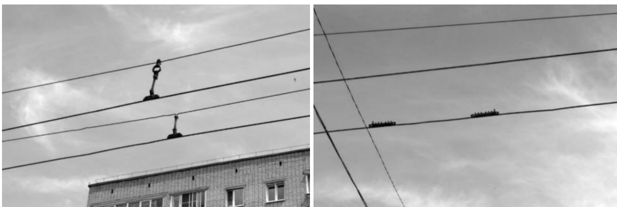
Рисунок 2.508 – Контактный провод троллейбуса
