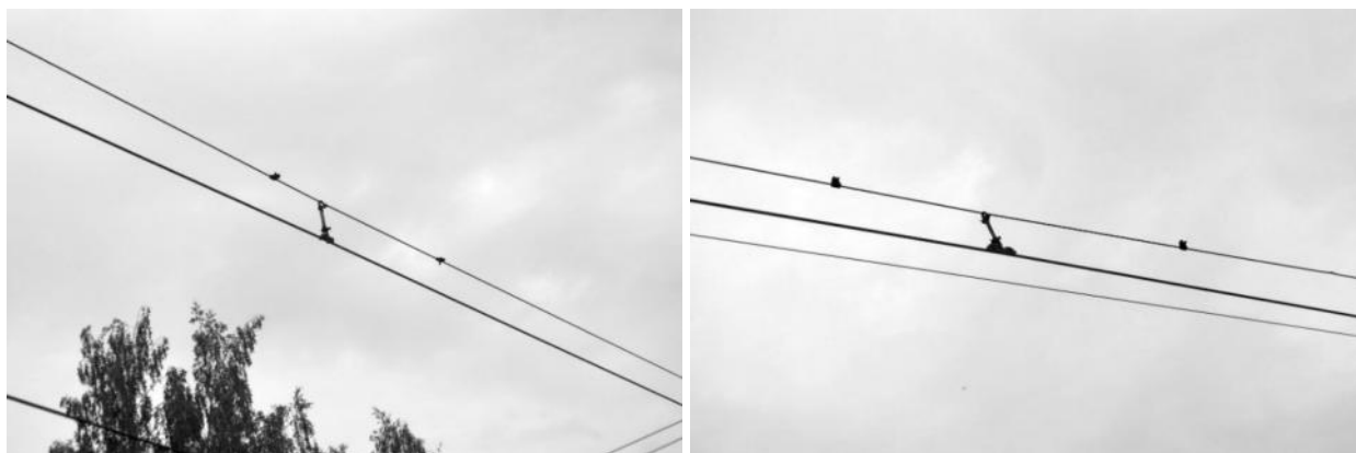
Рисунок 2.471 – Участок контактной сети
