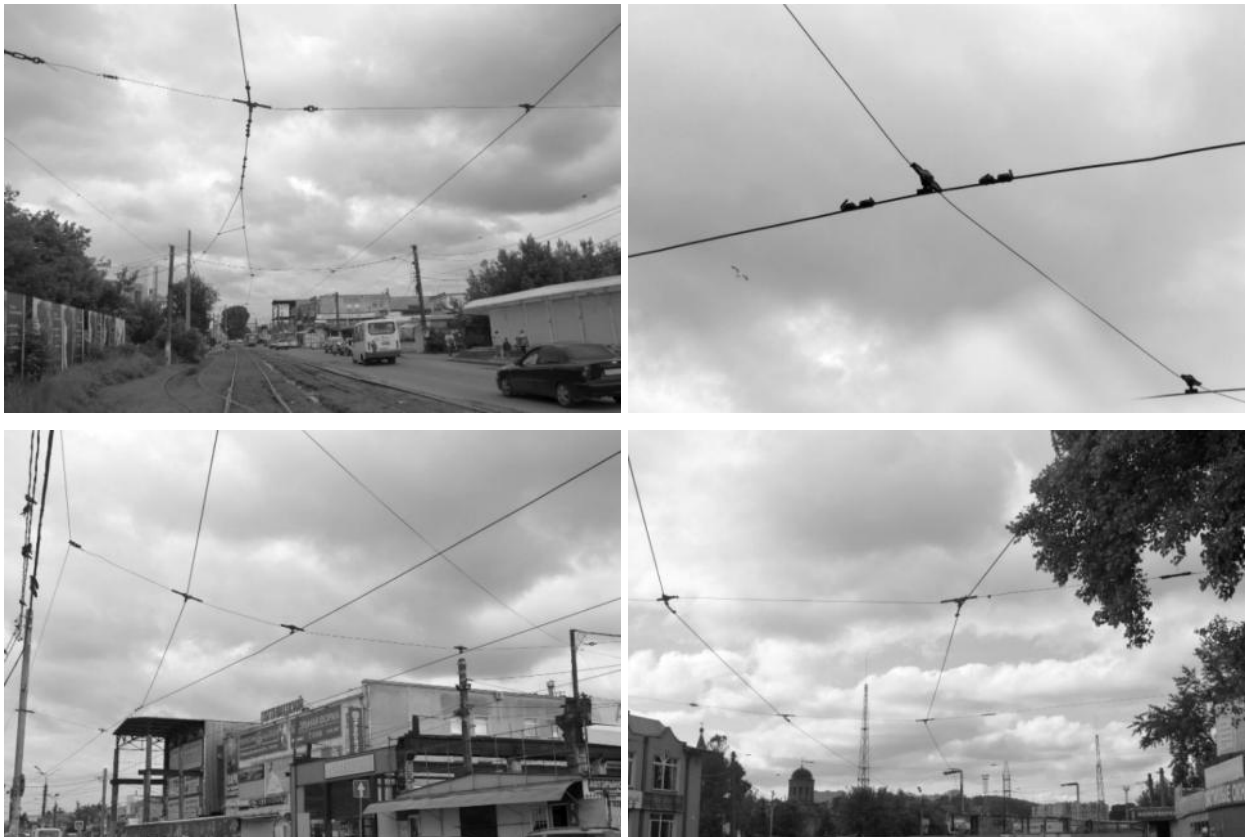
Рисунок 2.299 – Контактный провод трамвая
