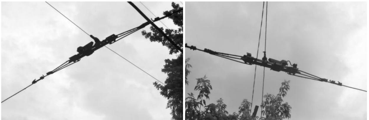
Рисунок 2.399 – Секционные изоляторы на участке контактной сети
